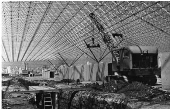
86. Construção do Anhembi - Miguel Juliano e Jorge Wilhelm, São Paulo, 1970-1973. Fonte: www.anhembi.com.br/40anos
