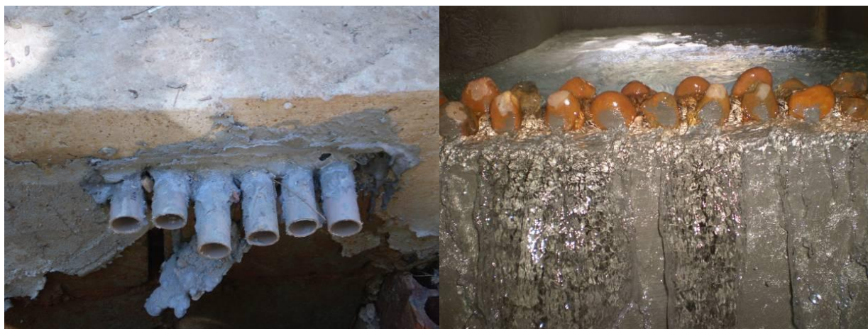
Figura 5.9 - Sistemas de Aeração com bicos de injeção de ar, e queda d'água, entre a caixa de aeração e a caixa de bombeamento.
