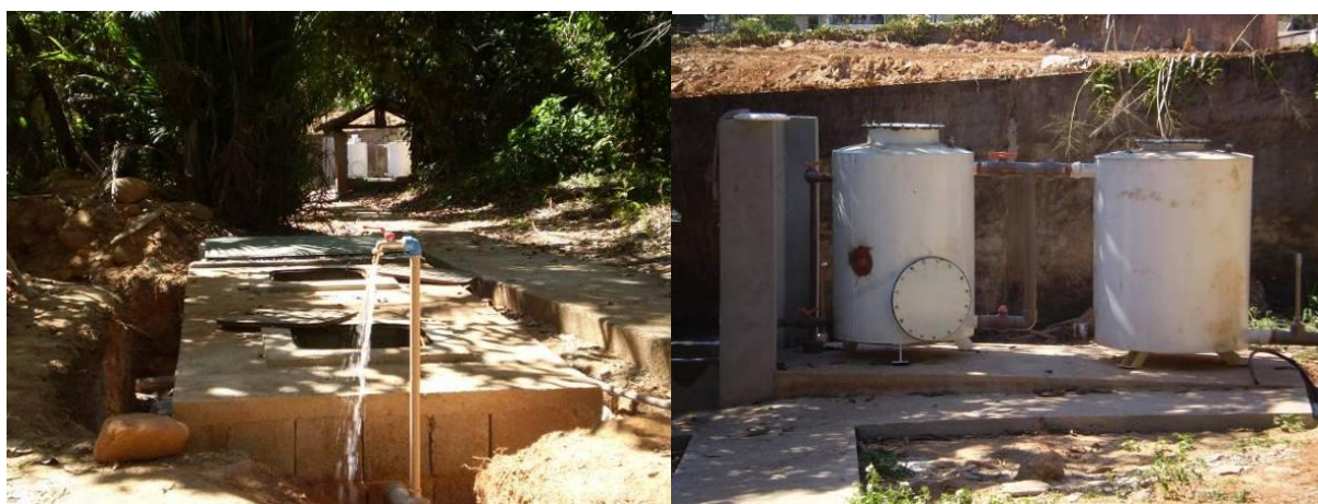
Figura 5.8 - Vista frontal da ETS. A esquerda entrada da caixa de aeração e caixa de bombeamento; e sistema de filtros integrados e aerador final (a direita).
