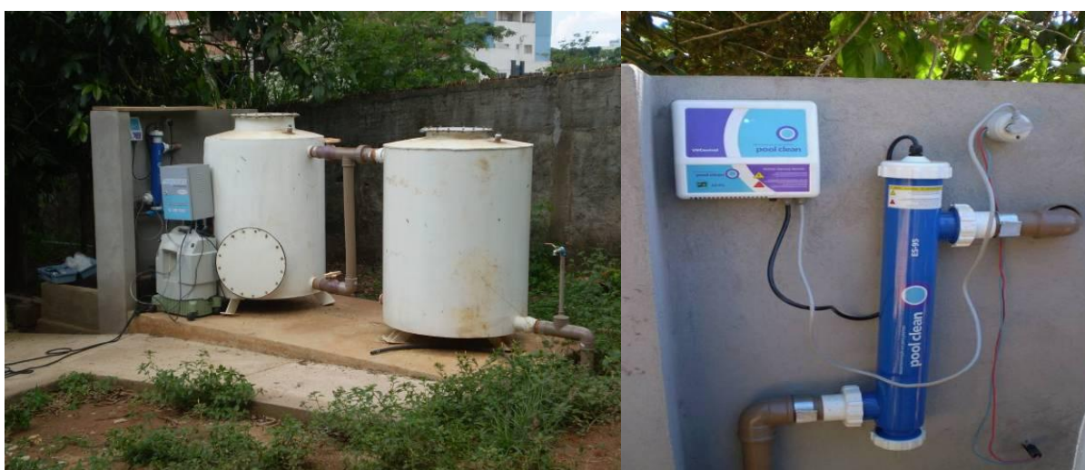
Figura 5.10 - Estação de Tratamento Simplificado - ETS, com filtro ultravioleta em detalhe.
