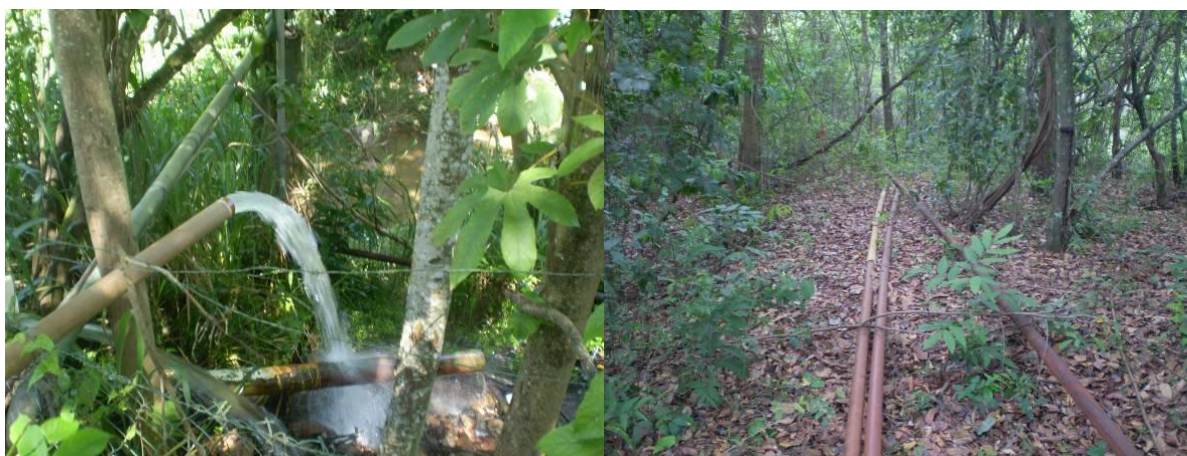
Figura 5.7 - Lançamento de efluentes das piscinas termais diretamente no ribeirão Caldas; e tubulações que direcionam os efluentes para Estação de Tratamento Simplificada - ETS.
