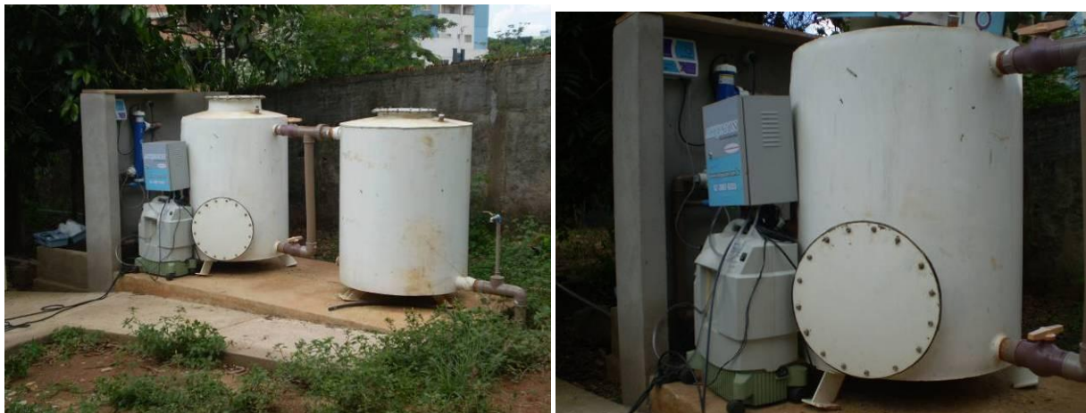
Figura 5.17 - Estação de Tratamento Simplificada, durante realização de ensaio com ozônio.
