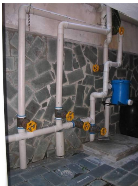
Figura 3.8 - Sistema de tubos para captação de águas pluviais, proposto por Silva (2004), Silva et al. (2004) e Montenegro et al. (2005).
