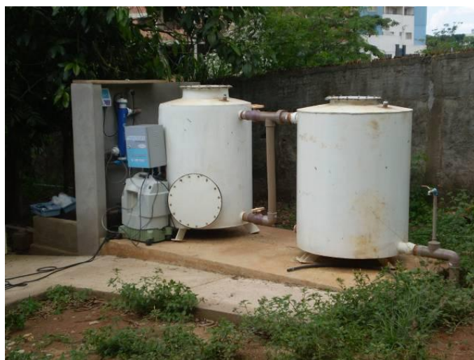
Figura 4 - Estação de Tratamento Simplificada - ETS.
