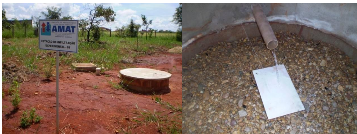
Figura 5.1 - Sistema Piloto de Recarga Artificial. Poços rasos preenchidos com material granular. Estação Experimental 1 - AMAT.
