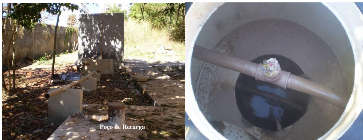
Figura 5.11 - Saída de água da ETS, com poço de recarga ao lado; e parte interna do filtro integrado.
