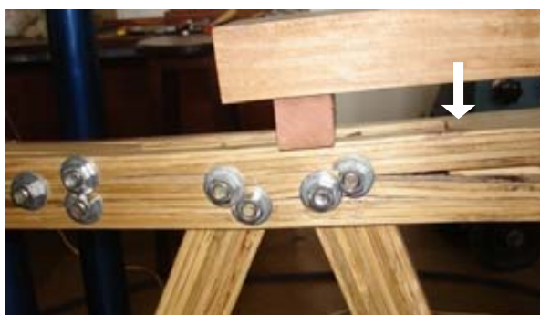
6. Ruptura na linha de cola.
