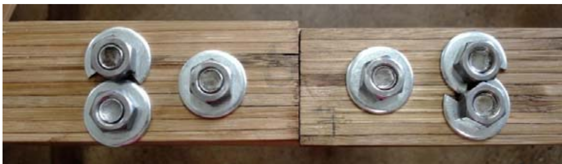
Figura 106: Irregularidade dimensional entre a união das peças compostas. Fonte: Foto da autora.
