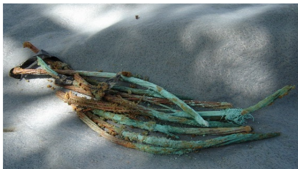
Figura 7.26 - Cordoalhas de cobre rompidas no dreno ânodo.
