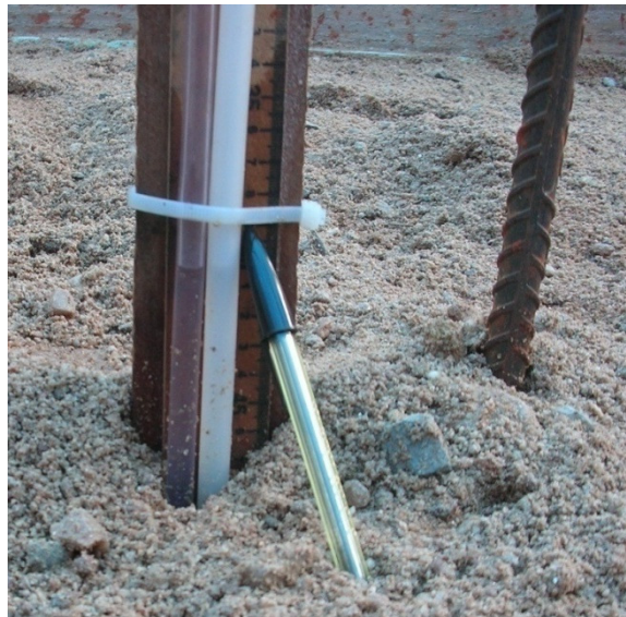
Figura 6.41 - Nível de água no piezômetro após depósito da camada drenante.
