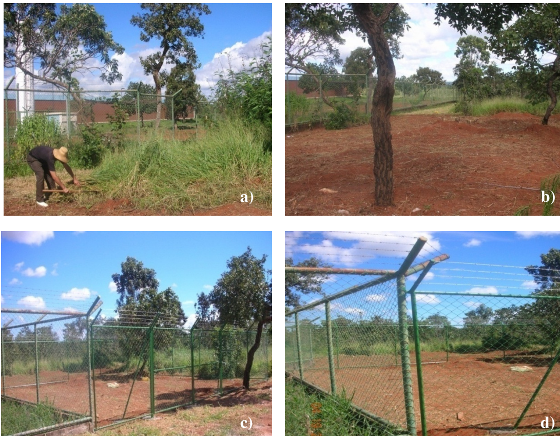
Figura 6.10 - Limpeza da área (a e b) e instalação de cerca de proteção (c e d).
