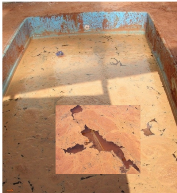
Figura 6.18 - Reservatório com solo mole próximo a cota de 75 cm, com destaque para lâmina d'água.
