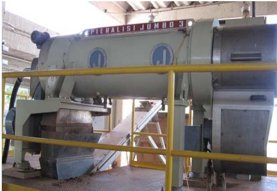
Figura 5.3 – Centrífuga da unidade de desidratação de lodo da ETA-Descoberto
