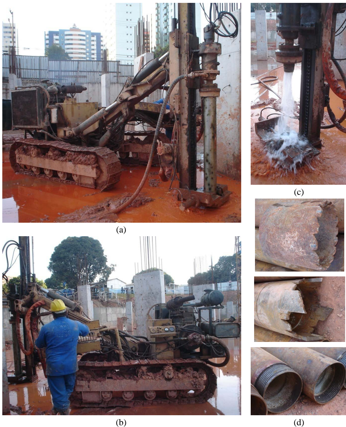
Figura 2.5 - Perfuração da estaca raiz: (a) lateral esquerda do equipamento, (b) lateral direita do equipamento, onde fica o painel de comando, (c) circulação de água no interior do tubo, (d) alguns tipos de coroas de perfuração e extremidades rosqueadas dos tubos metálicos.
