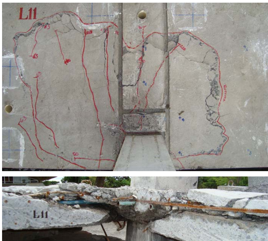
Figura 4.135 – Ruptura da laje do Modelo L11 – P1_D/P1_E = 2,0 ; P2 = 0,0 MPa.
