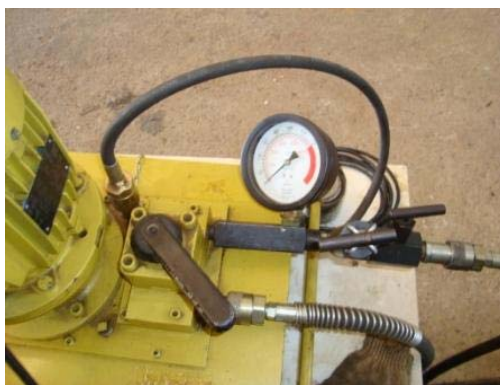
Figura 3.45 – Sistema de válvulas de ajuste fino.
