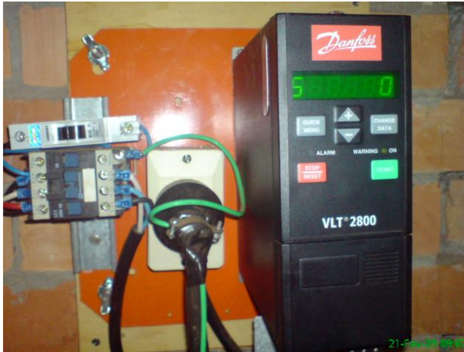
Figura 4.3: Variador de frequência
