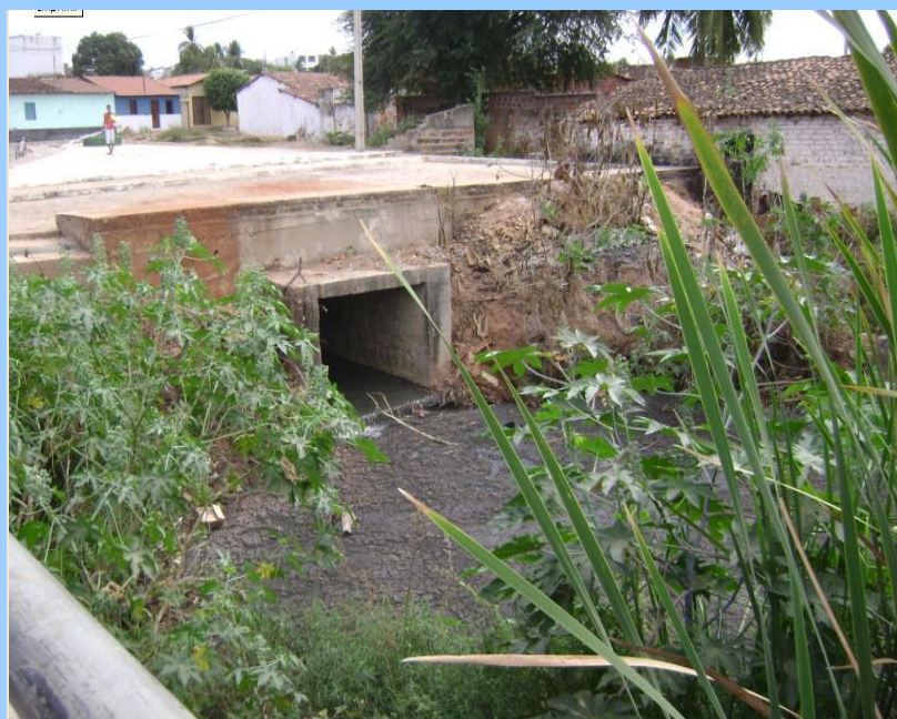
Figura 5– Lançamento de esgoto doméstico in natura no Rio do Antônio – Brumado-BA
