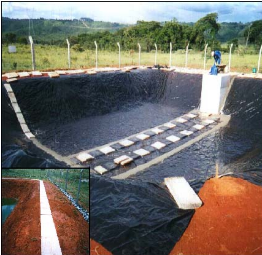
Figura 4.12 - Impermeabilização do Tanque 2 - fase final de fixação da lona na borda do talude - (no canto esquerdo inferior - detalhe do formigueiro principal)
