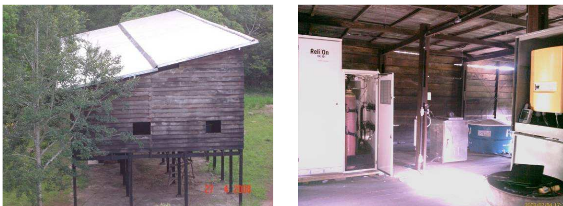
Figura 4.8 (a) Arranjo fotovoltaico; (b) CaC, eletrolisador, reservatório e inversores Sunny Island do SHGD instalado no CPC.
