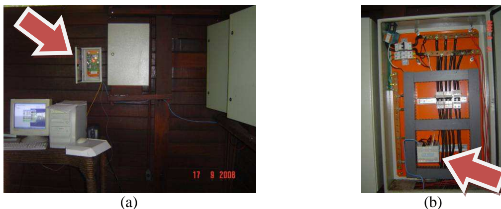
Figura 4.13 (a) Registrador de energia CCK5500 (b) Transdutor de energia CCK4200.
