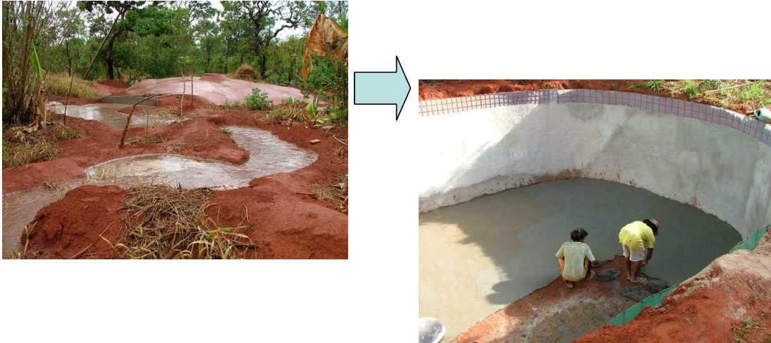
Foto 1 – Tanque de armazenamento de águas pluviais Fonte: www.chacaraasabranca.org.br
