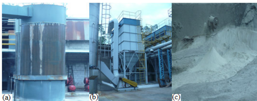
Figura. 3.5: (a) Sistema de resfriamento dos gases provenientes do forno rotativo, (b) Sistema de filtros mangas (c) local de armazenado do material particulado retirado do filtro mangas.
