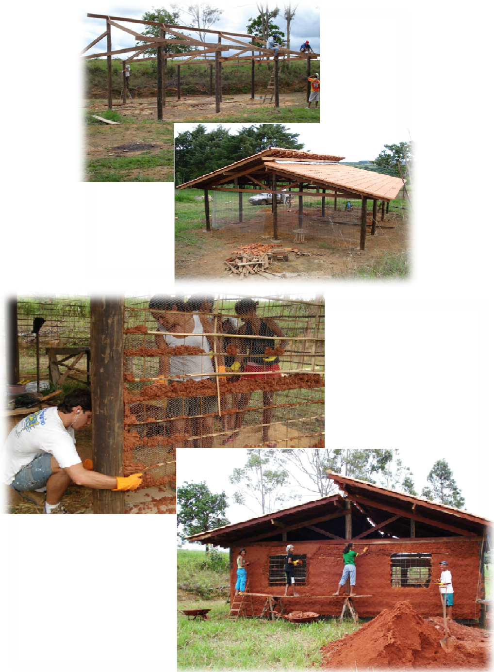
Figura 7 - Processo de mutirão para a construção da ecoteca. Fonte: fotos do acervo do Projeto Sombra da Mata
