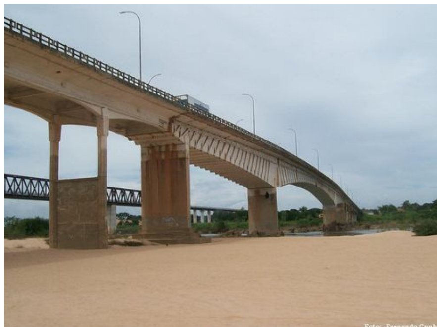
Figura 15: Foto das Pontes rodoviária e ferroviária sobre o rio Tocantins em Aguiarnópolis - TO
