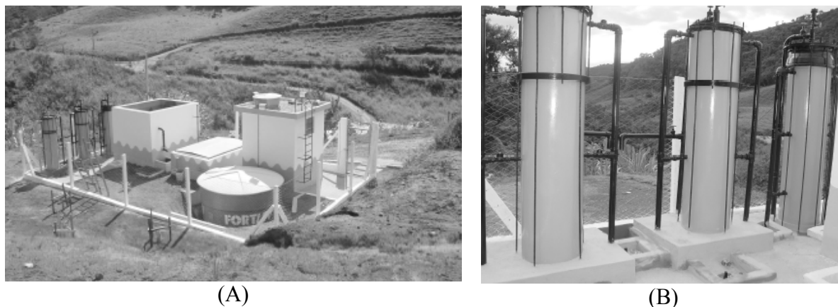
Figura 3.12: ETA Manhuaçu, MG, composta por FIME. (A) Vista aérea da ETA Manhuaçu: pré-filtros de pedregulho, filtro lento, tanque de contato, casa de química e reservatório; (B) pré-filtros de pedregulho tubulares semi-pressurizados. (Souza e Bahia, 2006)
