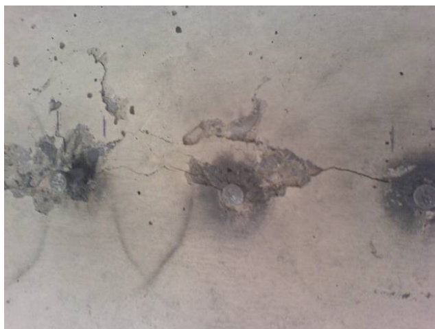
Figura 3-5 Interligação da fissura nos disparos com 5,0 cm de distância
