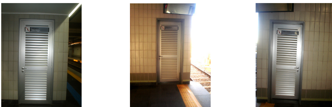
Ilustração 22 – Fotos das portas da Estação de Metrô Terminal Ceilândia com sinalização incorreta.
