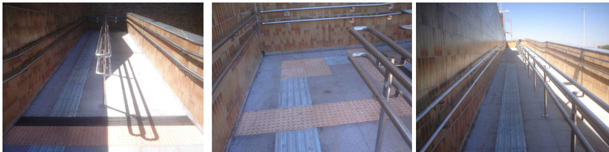
Ilustração 35 – Fotos das rampas da Estação de Metrô Terminal Ceilândia sinalizadas com pisos táteis de alerta e direcional.
