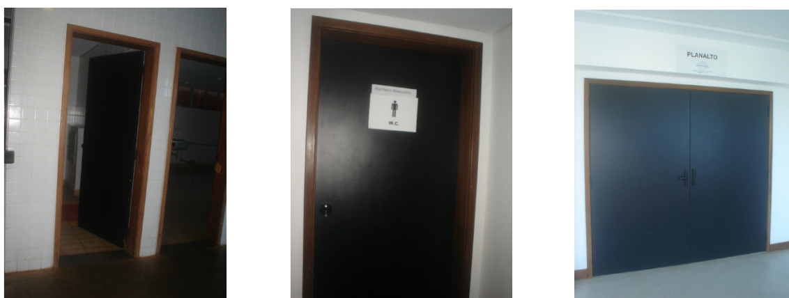
Ilustração 56– Fotos das portas do Centro de Convenções sem a sinalização adequada.
