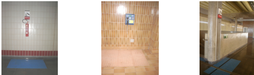
Ilustração 18 – Fotos dos obstáculos suspensos (extintores e orelhões) na Estação de Metrô Guararioba com sinalização de piso e até sem o obstáculo.
