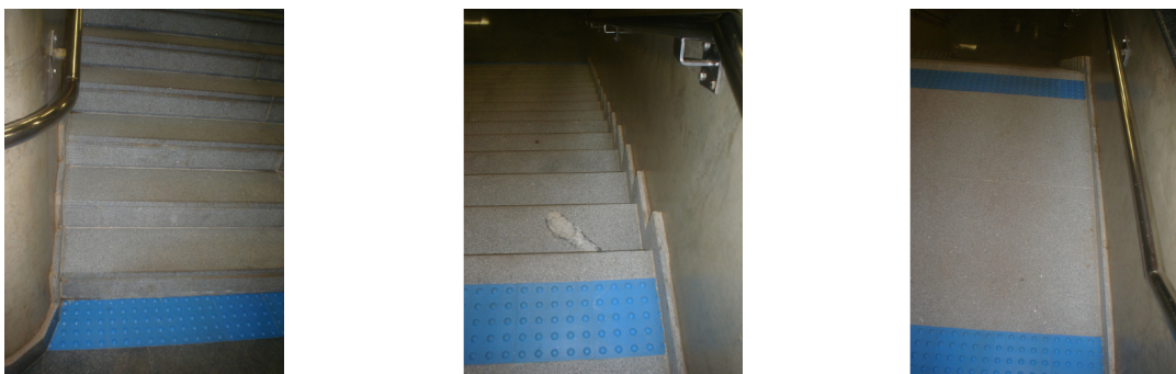
Ilustração 24 – Fotos das escadas da Estação de Metrô Guariroba com sinalização com piso tátil, mas sem a sinalização de degraus.
