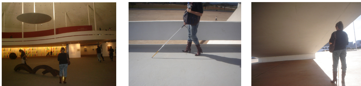
Ilustração 83 – Fotos do local de exposições sem o a sinalização tátil no piso, rampa com o guarda-corpo menor que o exigido norma técnica e sem corrimão, e rampa (funcionando como um obstáculo suspenso) sem sinalização adequada na parte inferior, passeio acompanhado com Isabel no Museu Nacional.
