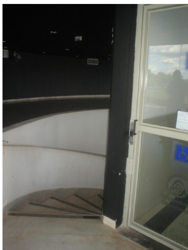
Ilustração 60 – Foto da escada fixa do Museu Nacional sem a sinalização e o corrimão recomendados pela norma técnica.
