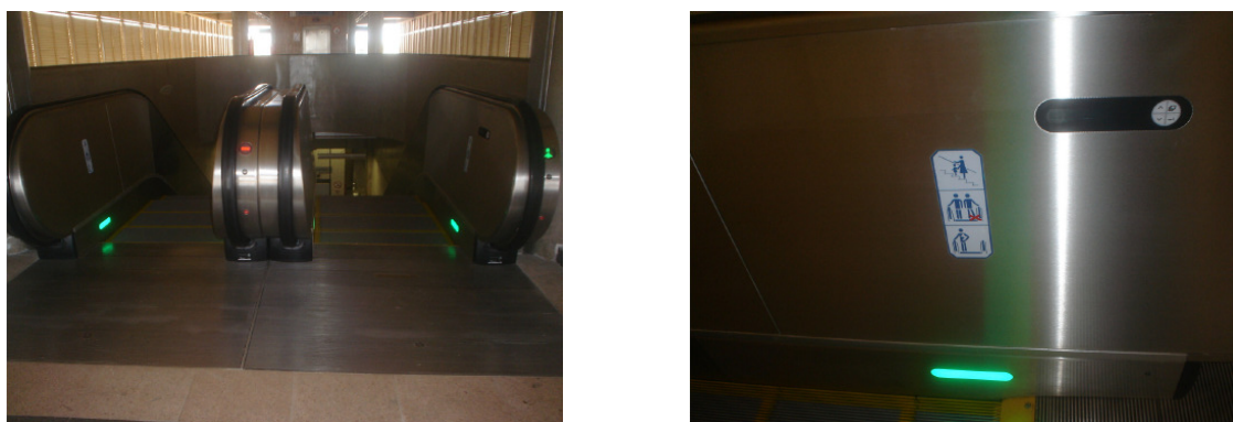
Ilustração 37 – Fotos das escadas rolantes da Estação de Metrô Guariroba sem a sinalização exigida pela norma técnica.
