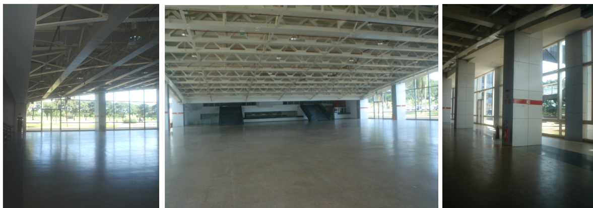
Ilustração 62 – Fotos do piso do Centro de Convenções sem a sinalização tátil.
