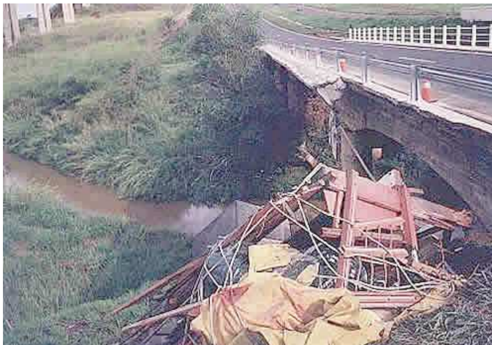
Figura 5 – Capotamento de Caminhão Transportando Carga Fracionada
