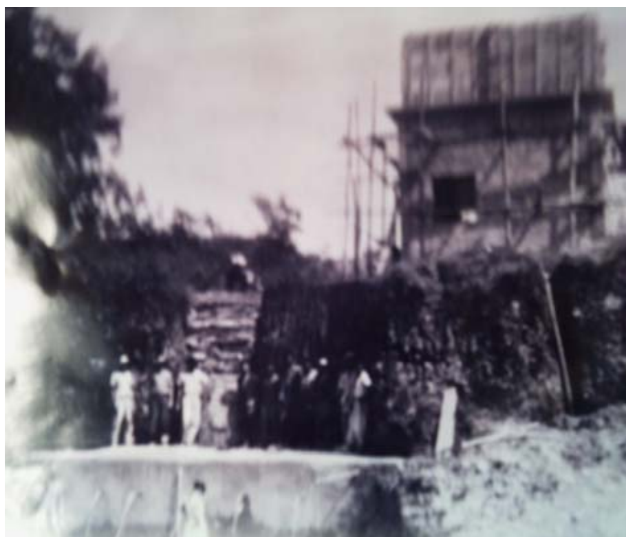
Fig. 36. Construção de Caixa de água, nas Três Bicas. (cerca 1950). Fonte: Acervo Casa da Cultura
