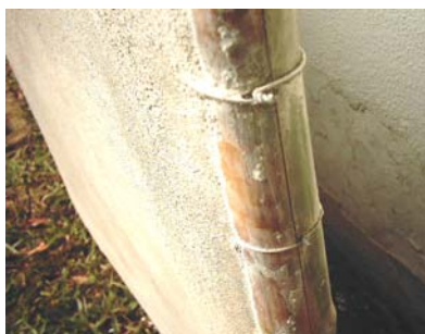
Figura 165 - Detalhe do encontro da argamassa de revestimento com a moldura de bambu. ( Fonte: Foto da autora, 2005)
