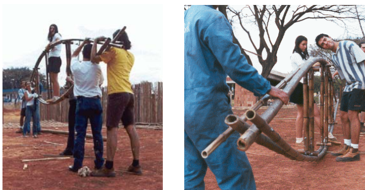
Figura 48 - (a) e (b) Treliça plana (viga), construída na Terra Indígena dos Krahô, TO. (Fonte: Arquivo Cantoar - FAU/UnB).
