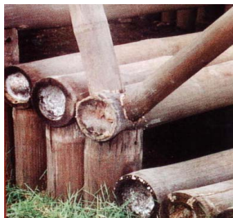
Figura 53 - Escada de bambu construída de maneira não recomendada, permitindo o contato do bambu com o solo. (Fonte: IL31 BAMBOO, 1992, p.34).
