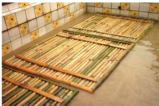
Figura 153 - Estruturas de bambu imersas na calda de cimento. (Fonte: Foto da autora, tirada durante a etapa de execução, 2005).
