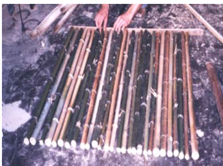
Figura 145 - Organização das varas de preenchimento no solo. (Fonte: Foto da autora, tirada durante a etapa de execução, 2005).
