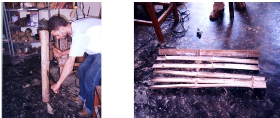
Figura 140 - (a) O colmo do bambu é aberto manualmente (b) e se tornam tiras, utilizadas nos painéis como travessas de fixação. (Fonte: Foto da autora, tirada durante a etapa de execução, 2005).
