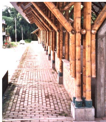
Figura 46 - Pilares de bambu. Centro de Desarrollo Artesanal de Risalda, Colômbia. (Fonte: Foto da autora, Colômbia, dezembro de 2005).
