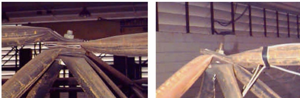
Figura 2.46 – Deformada dos nós após ruína (Souza, 1998)
