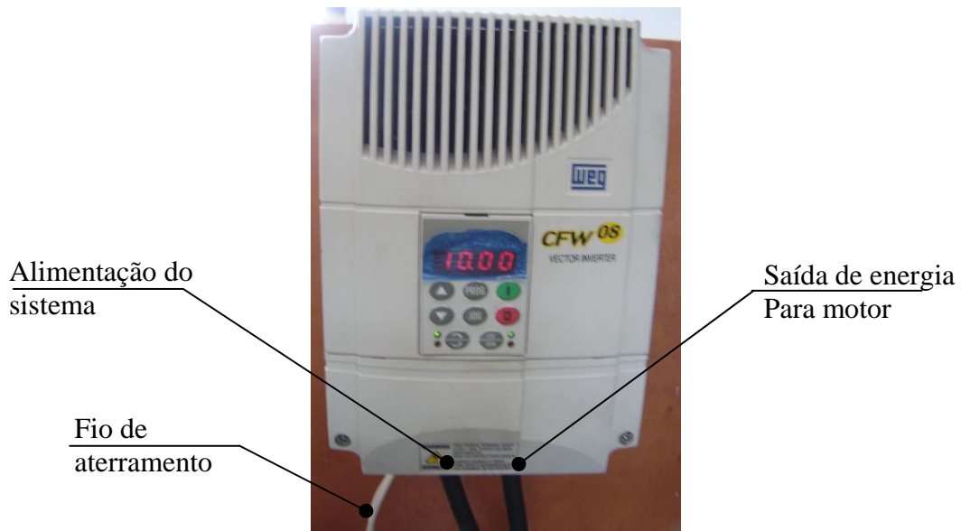
Figura 6.10 – Inversor de frequência do motor elétrico
