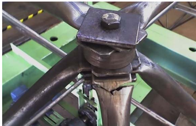
Figura 6.21 – Detalhe da ruptura da diagonal no ensaio do protótipo LTDCD2
