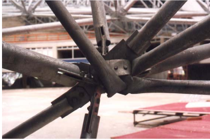
Figura 1.5 – Detalhe da deformada do nó após colapso
