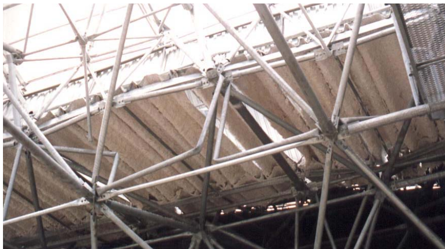
Figura 1.4 – Detalhe de barras com flambagem
