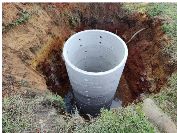
Figura 4.28: Poço de infiltração - detalhe do processo de construção com anéis de concreto.
