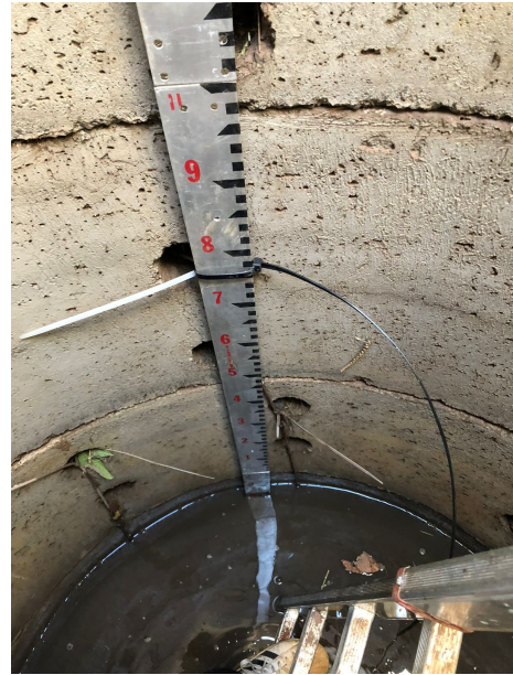
Figura 4.33: Poço de infiltração - detalhe da régua linimétrica e nível d'água.
