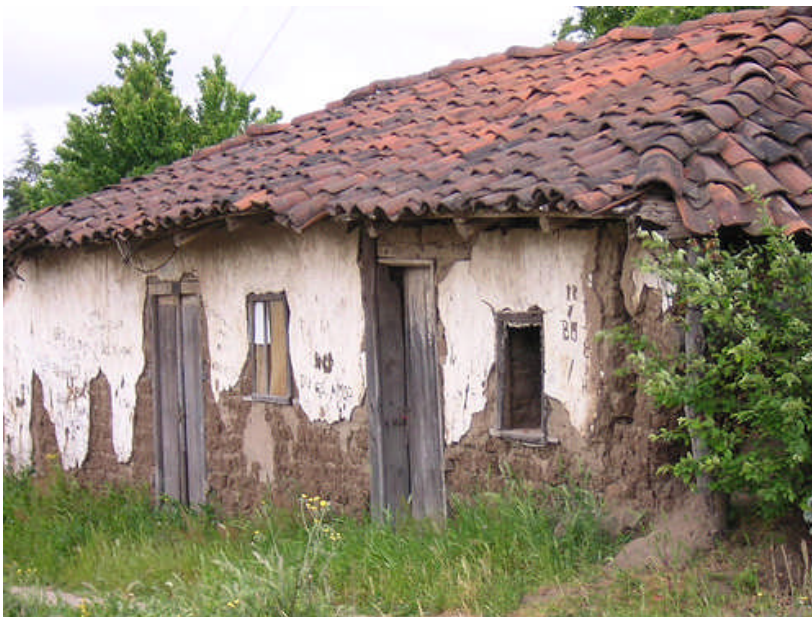
Figura 7: Edificação em adobe deteriorada Fonte: Fernandez, 2006.
