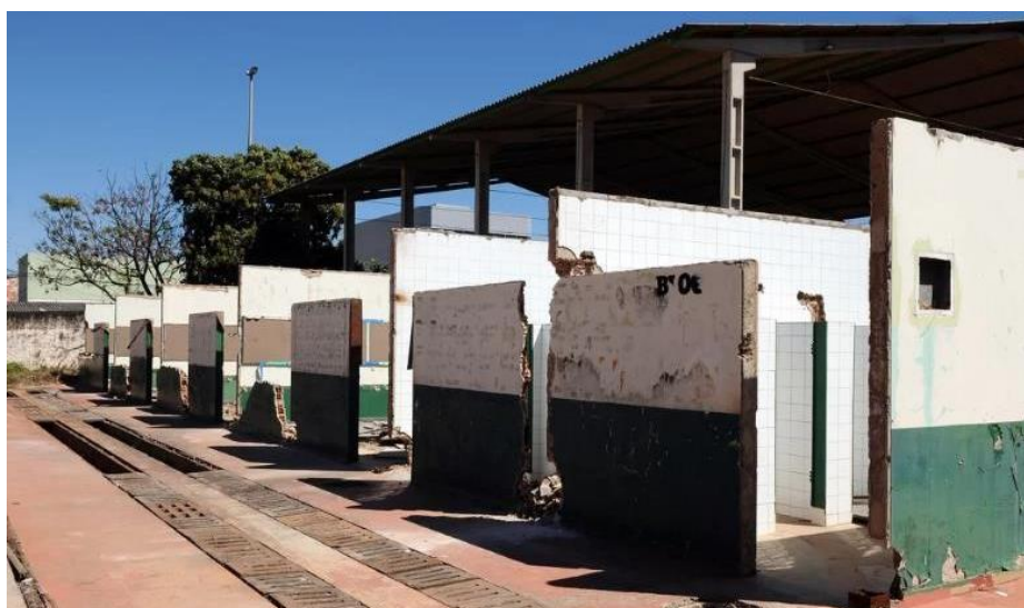
Figura 3- Escola antes da reforma - Metrôpoles
