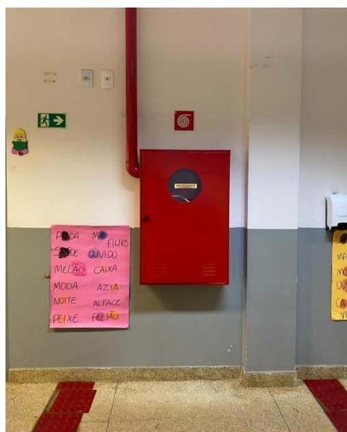
Figura 20 - Hidrante e sinalização – Autoral.
