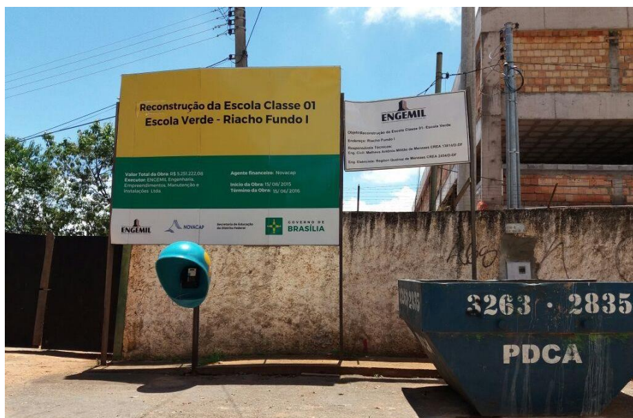
Figura 4 - Placa de identificação da obra - Rodolpho Pontes
