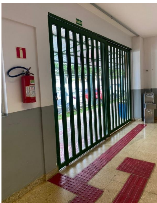
Figura 22 - Extintor, saída de emergência e sinalização - Autoral.
