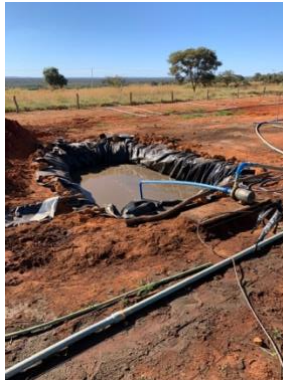
Reservatório de ARB pós tratamento preliminar
