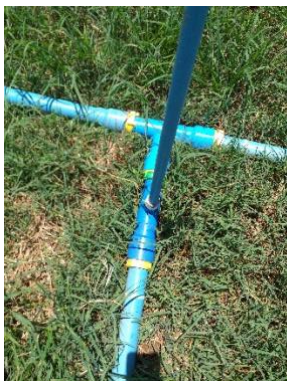
Detalhe das conexões hidráulicas
