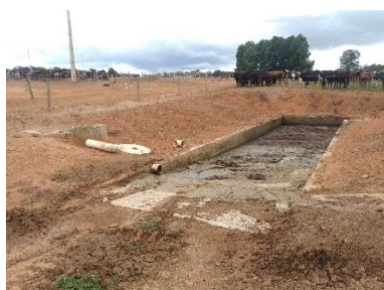
Tanque separador de sólidos grosseiros
