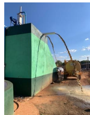
Despejo da ARB após a remoção de sólidos (tratamento preliminar)
