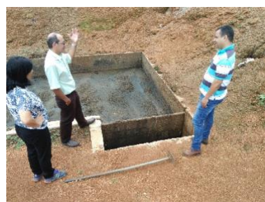
Tanque separador de sólidos grosseiros
