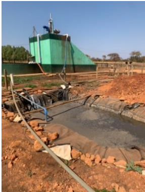
Reservatório de ARB pós tratamento preliminar
