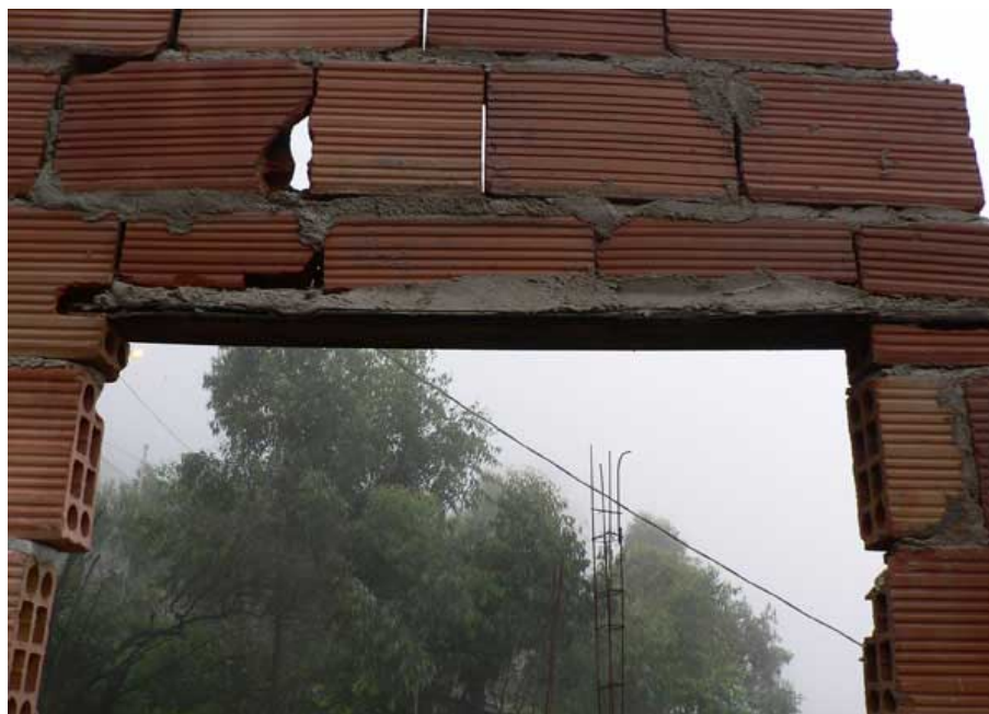
Figura 5.2 – Verga com barra de aço na junta de argamassa, usando como forma um pedaço de madeirite engastado no próprio bloco cerâmico. Fonte: Foto tirada na obra em 1998.
