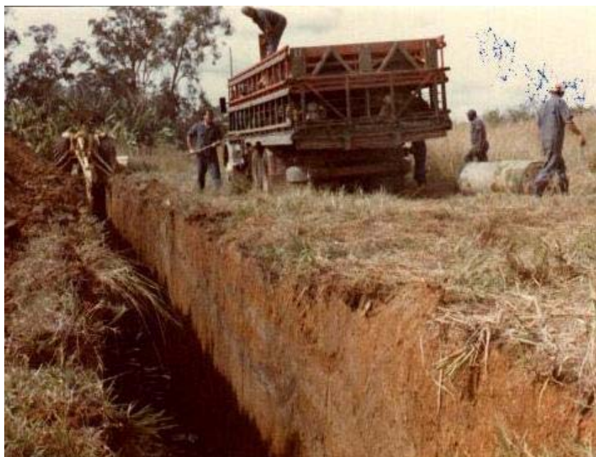
FIGURA 24 Valas profundas e extensas, onde após o sacrifício sanitário e era realizada a cremação de suínos pela equipe de Defesa Sanitária Animal.
