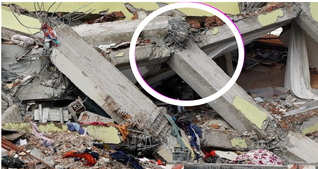
Figura 33. Insuficiência de armadura lateral na região de rótulas plásticas verificada em edifício colapsado no terremoto da Turquia (2023). Fonte: Suhaib Salem/Reuters, 2023.
