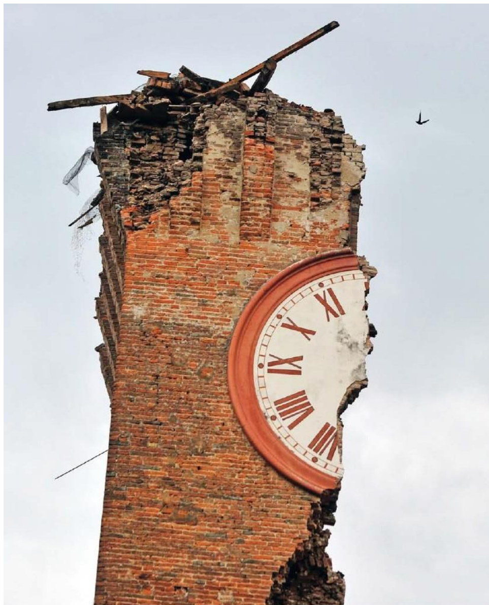
Figura 1. Torre do Relógio danificada por terremoto em Emilia Finale. Fonte: Sandaker, 2019.
