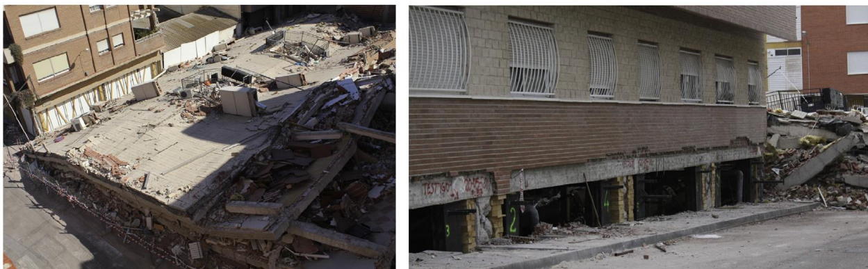
Figura 29. Falha por cisalhamento em pilares curto. Fonte: Romão et al, 2011.
