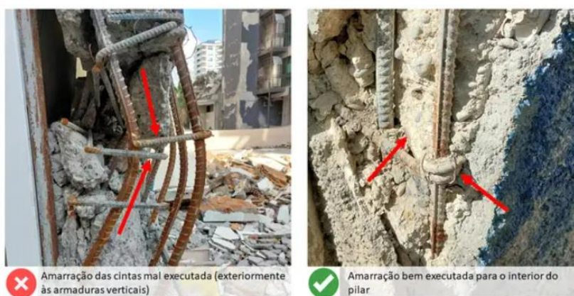
Figura 32. Amarração Mal executada (Ganchos) em edificações danificadas no terremoto da Turquia (2023). Fonte: Cristina Oliveira, 2023.
