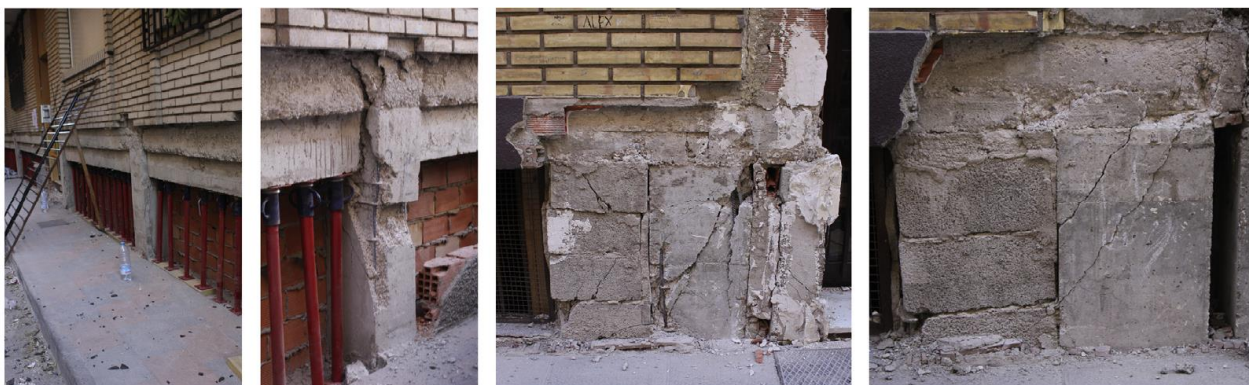
Figura 30. Mecanismo de pilar curto em edificações devido ao pavimento da garagem estar parcialmente enterrado. Fonte: Romão et al, 2011.
