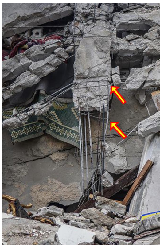
Figura 31. Ausência de armadura transversal em pilares pós-terremoto da Turquia (2023). Fonte: Garini & Gazetas, 2023.
