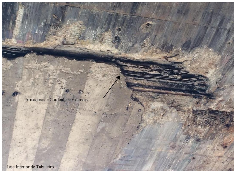
Figura 69 – Armaduras Passivas e Cordoalhas de Protensão Expostas Laje Superior do Tabuleiro (Quebra da Mísula da Longarina para colocação de Visita)
