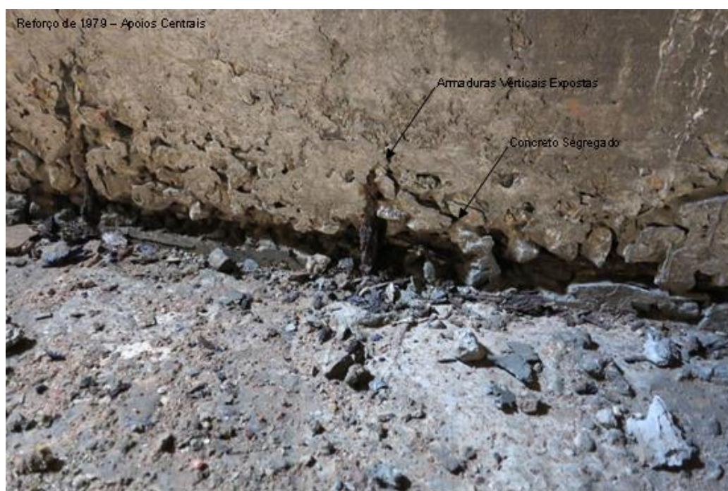
Figuras 67 – Regiões com Baixo Cobrimento e Armaduras Expostas Vigas Transversinas de Topo
