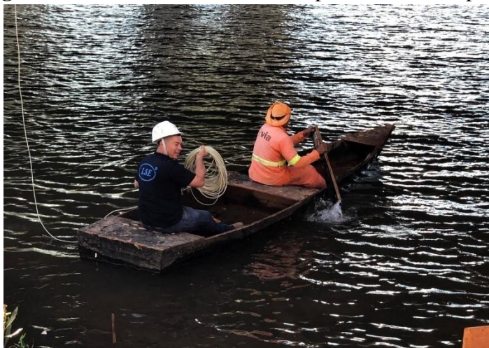
Figura 121 – Sensores instalados na parte inferior da ponte
