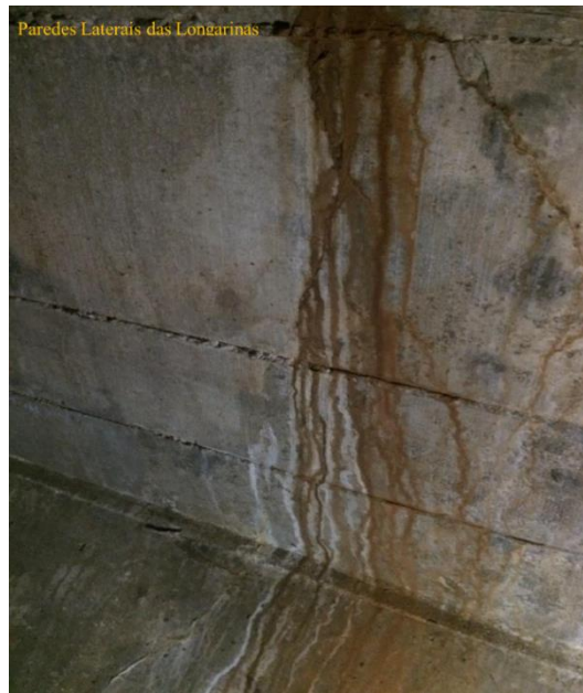
Figura 74 – Trincas nas Paredes das Longarinas. Pontos de Infiltração, Carreamento de Material, Ferrugem e Coloração Alaranjada no Concreto
