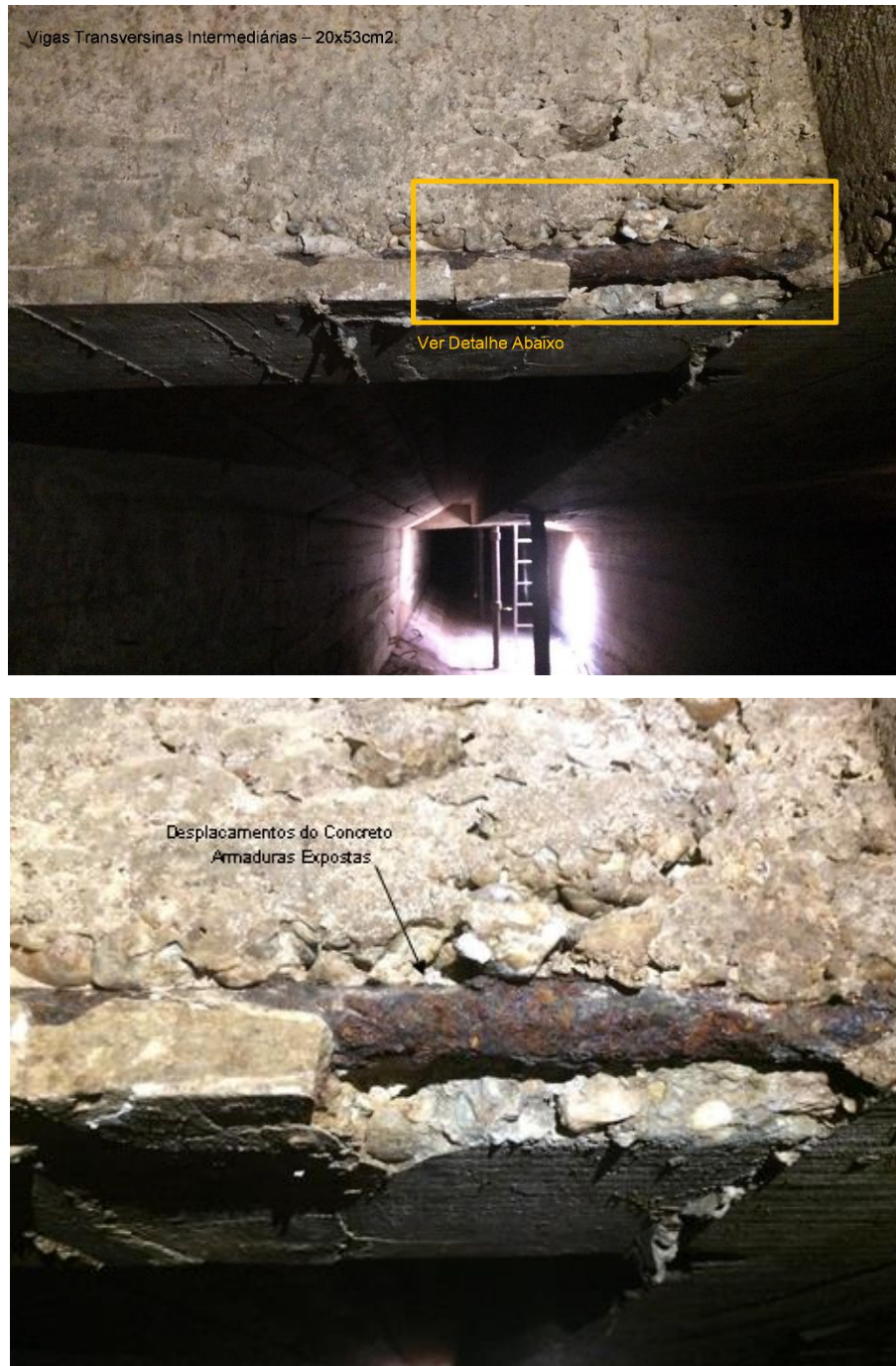
Figura 68 – Armaduras Passivas e Cordoalhas de Protensão Expostas Laje Inferior do Tabuleiro (Colisão de Veículos)
