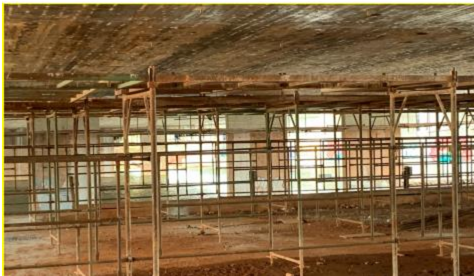
Figura 6 – Vista da face inferior do tabuleiro central – danos ocasionados pela humidade
