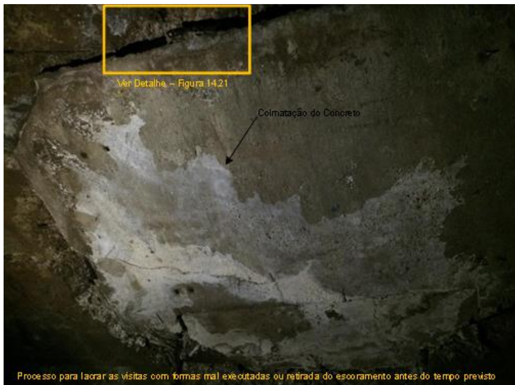
Figura 64 – Deslocamentos do Concreto na Laje Superior e Armaduras Expostas
