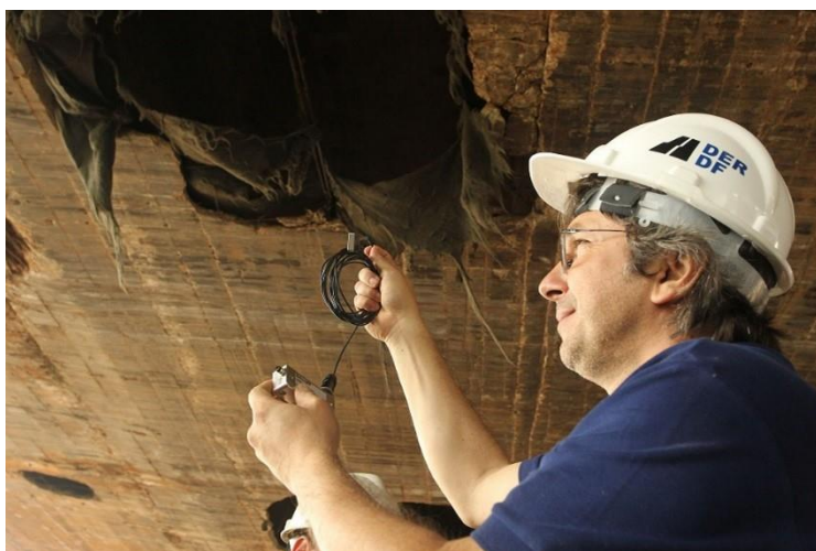
Figura 18 – Vistoria na face inferior, furos no concreto devido ao impacto de veículos. Diretor do DER em 2018
