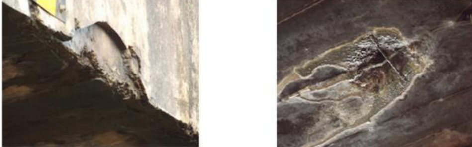
Figura 131 – Danos na laje inferior do caixão perdido
