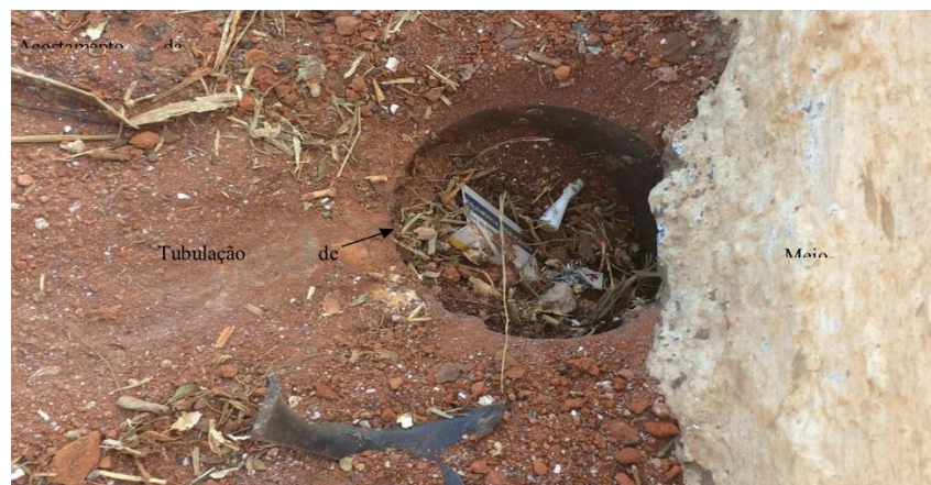
Figura 61 – Tubulações de Drenagem de Água Pluvial nas Laterais da Pista de Rolamento. (Observação: Tubulação totalmente obstruída)
