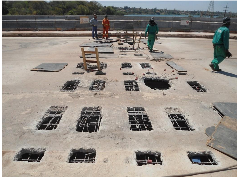
Figura 98 – Abertura no tabuleiro
