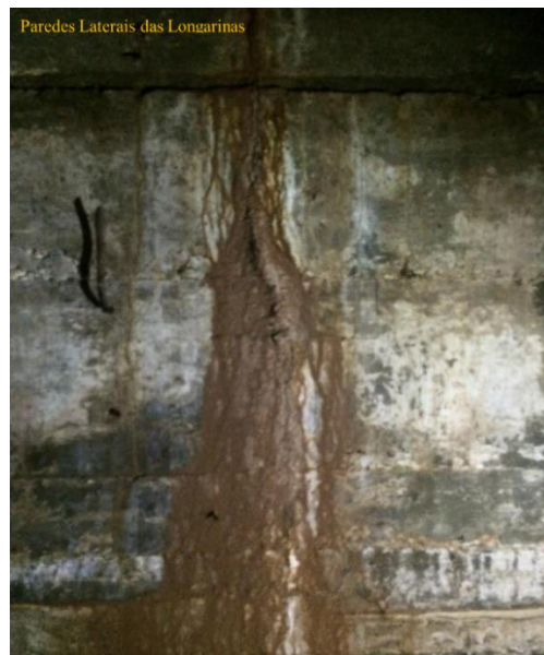
Figura 75 – Trincas nas Paredes das Longarinas. Pontos de Infiltração, Carreamento de Material, Ferrugem e Coloração Alaranjada no Concreto
