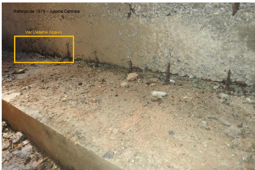
Figuras 66 – Regiões com Concreto Segregado, Baixo Cobrimento e Armaduras Expostas
