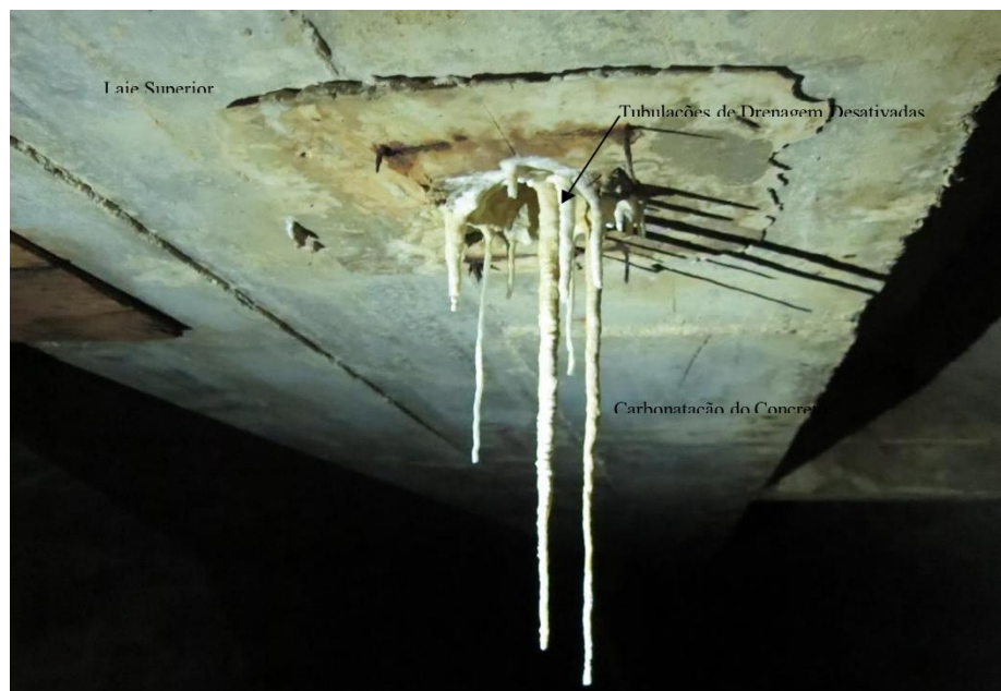
Figura 58 – Tubulações de Drenagem - Infiltrações de Água e Deslocamentos do Concreto
