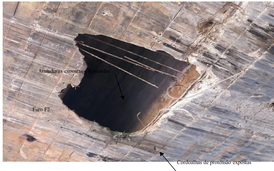
Figura 52 – Furos Existentes e Reparos na Laje Inferior do Tabuleiro
