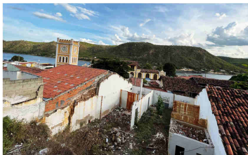
Figura 57 – Vazio urbano, perdem-se as configurações internas, mantendo apenas a fachada. Fonte: fotografia autoral, 2023.
