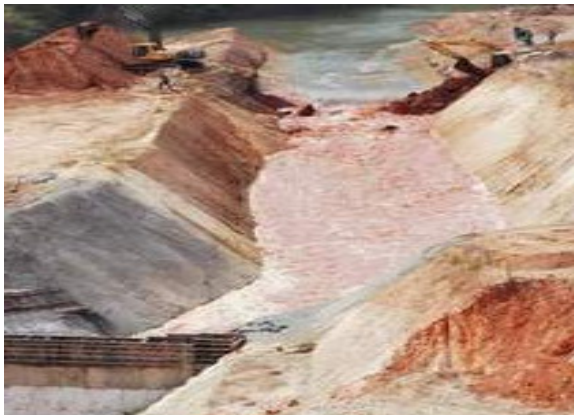
Figura 5C - Liberação da passagem das águas do ribeirão João Leite pelo desvio. Fonte: SANEAGO (2005).
