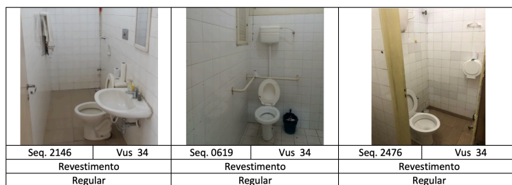
Figura 60 - Estado de conservação Regular - Vus 34 anos.
