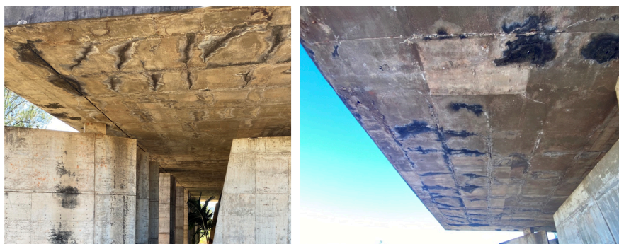
Figura 125- Danos no subsolo da BCE – falhas no sistema de drenagem. Fonte: LabRAC.
