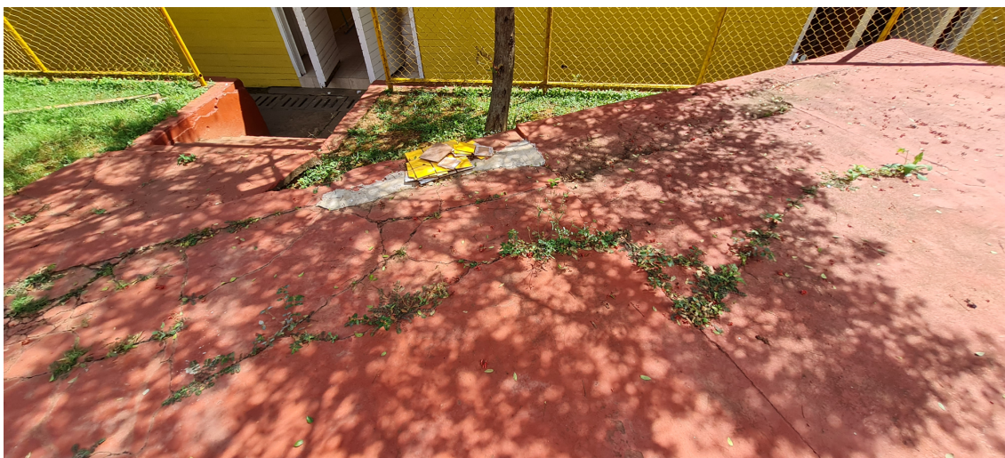
Figura 95 – Piso danificado e acessibilidade comprometida.
