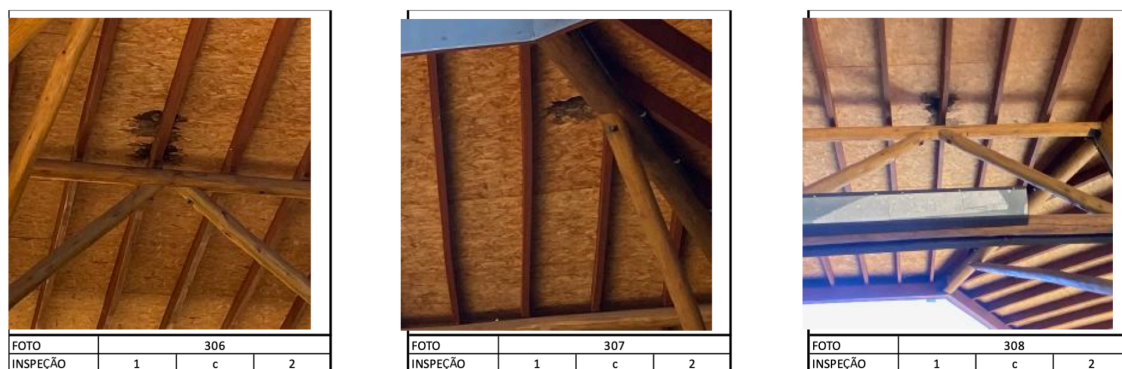
Figura 117 – Falhas na impermeabilização da cobertura.
