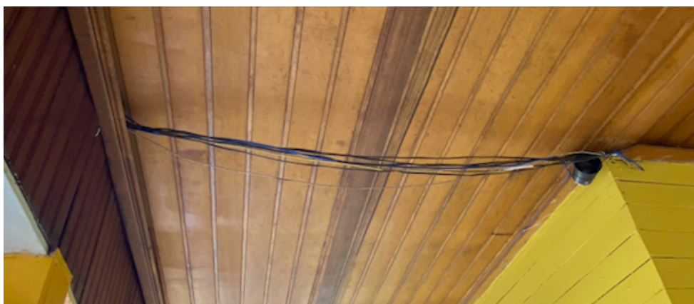
Figura 96 – Sistema elétrico - fiação exposta sem proteção.
