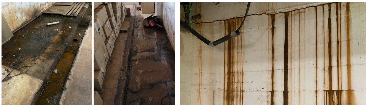
Figura 124- Danos no subsolo da BCE – falhas no sistema de drenagem. Fonte: LabRAC.
