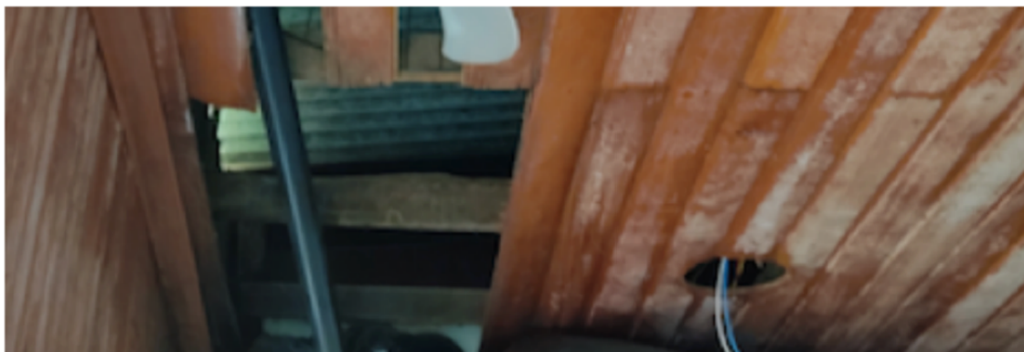
Figura 75- Forro original do módulo histórico - Imóvel educacional.
