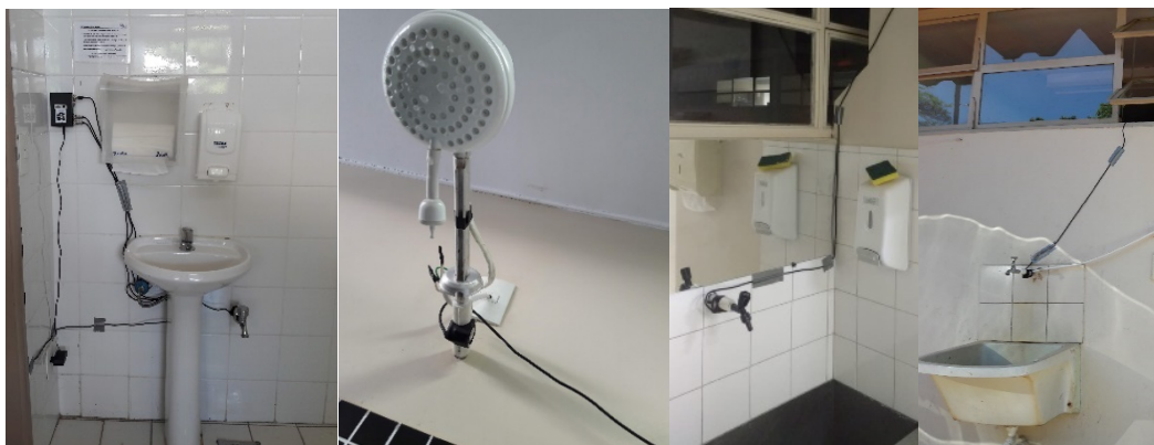
Figura 1: Medidores de fluxo instalados em lavatórios, chuveiros e torneiras, conectados a módulos data logger
