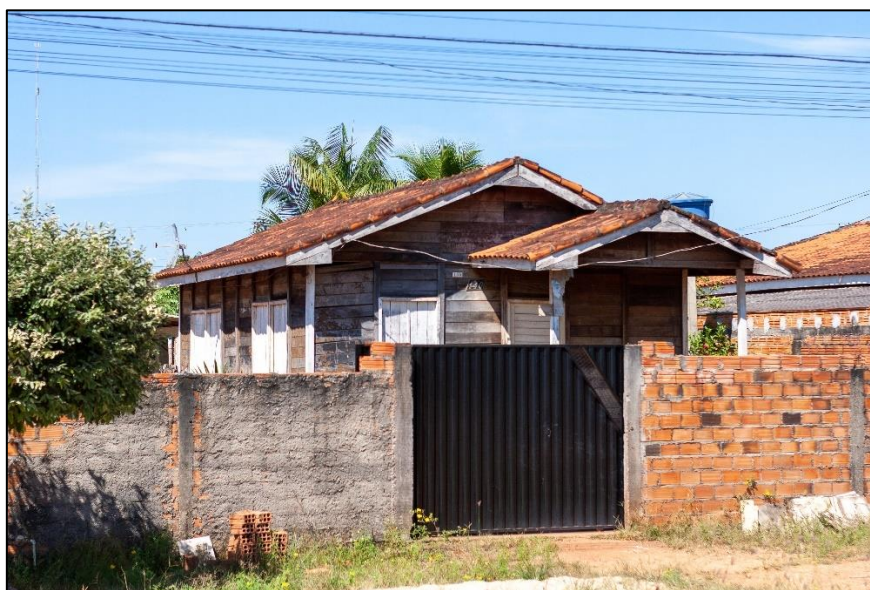
FIGURA 4. Imagem de moradia desocupada, mas em bom estado de conservação. Fonte: Imagem capturadas por Ícaro Benetti, julho 2021.
