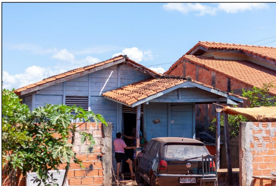
FIGURA 5. Imagem de moradia necessitando de reparos.
