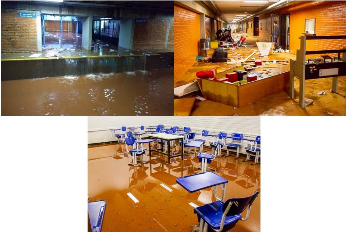
Figura 57 – Prejuízos materiais causados pela precipitação que ocorreu no dia 22/04/2019 no Instituto Central de Ciências da Universidade de Brasília, Campos Darcy Ribeiro, localizado na Asa Norte – Plano Piloto.
