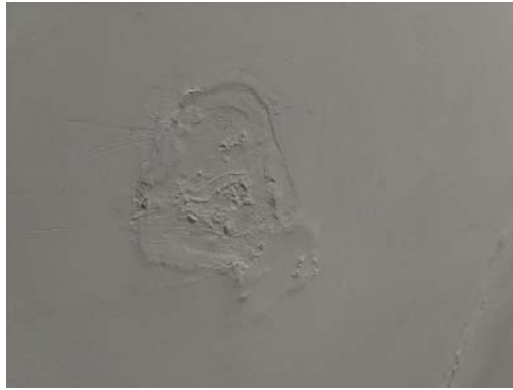
Figura 27: situação da pintura pelos efeitos da umidade excessiva próximo à base da cúpula, no andar
