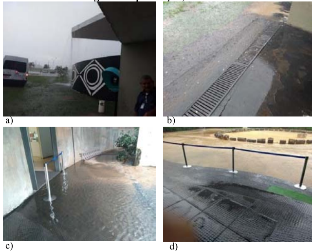
Figura 17: Problemas de drenagem e implantação, relacionados também à chuva dirigida.
