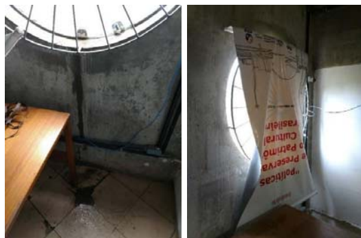
Figura 16: Janelas do MPI. a) Entrada de água pela esquadria do depósito do MPI e danos ao concreto e ao piso. b) Grades na esquadria para minimizar problemas de segurança e banner sendo utilizado para reduzir a luminosidade e diminuir a visibilidade do espaço interno pelo exterior do edifício.
