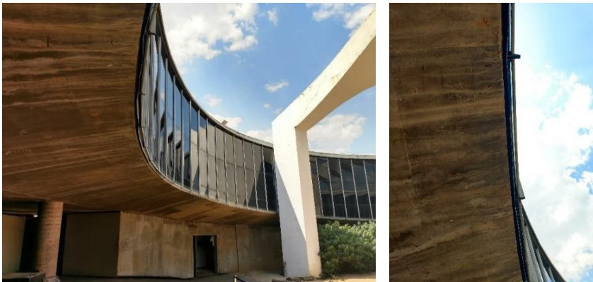
Figura 12: Eflorescências nas interfaces entre o sistema de concreto armado e o sistema de fachada cortina.
