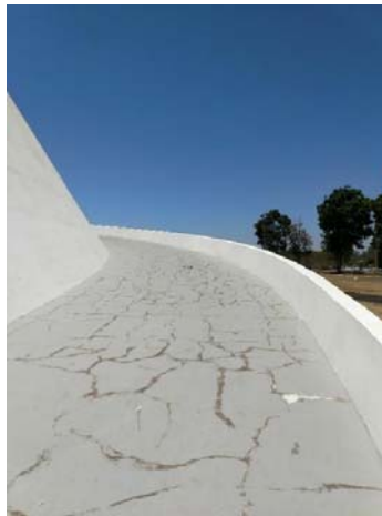
Figura 28: Fisuras no piso ao longo da rampa lateral do MuN
