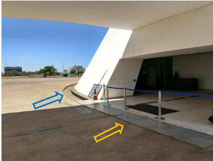
Figura 30: Entrada principal do piso térreo do MuN. A seta amarela mostra a direção de entrada da água da chuva e as grelhas metálicas. A seta azul mostra a vala criada ao redor da extensão da base da cúpula para drenagem de águas pluviais.
