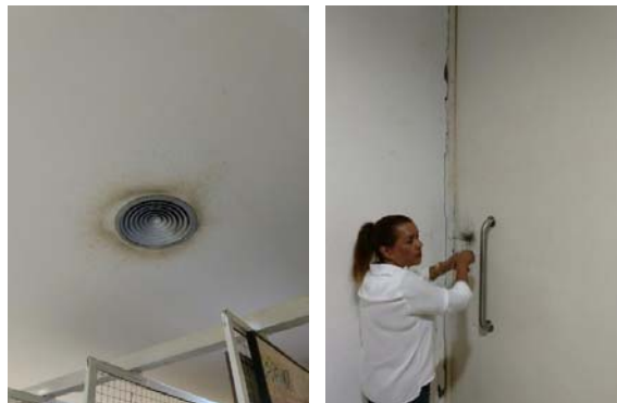
Figura 29: manifestações patológicas na reserva técnica principal. a) manchas encontradas nas saídas de ar condicionado. b) fissuras na interfaces da porta com o fechamento vertical da reserva técnica.
