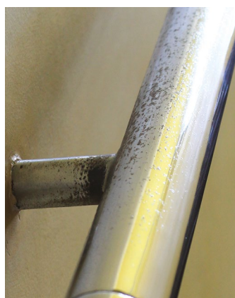
Figura 7.19. Corrimão da escada. Aço cromado. Pontos de oxidação e perda da camada superficial.
