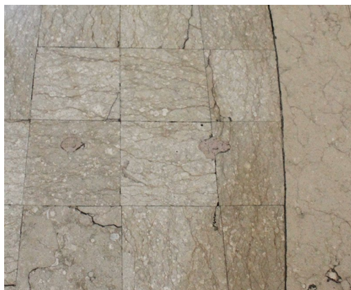
Figura 5.30. Sede do Fluminense Clube, Rio de Janeiro. Mármore em placas delgadas da escadaria. Fissuras, lacunas e sujidades que remetem ao uso continuado.
