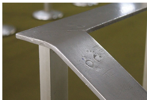
Figura 5.35. Palácio do Congresso. Guarda corpo da escadaria do Salão verde, em aço inoxidável, com marcas associadas à execução e ao uso continuado.
