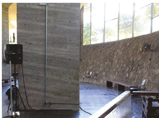
Figura 7.73. Alterações na nave. Tubulação para instalações elétricas, caixas de som e ventiladores.
