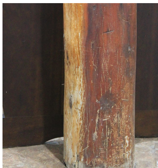
Figura 5.112. Igreja do Divino Espírito Santo. Pilar da nave. Arranhões associados ao uso e alteração cromáticas na base resultante da limpeza.
