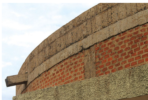
Figura 5.50. Igreja do Divino Espírito Santo, em Uberlândia. Concreto recentemente limpo, com marcas de execução e difícil identificação de alterações no tempo.
