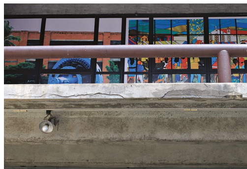
Figura 5.47. Sede da Companhia Hidrelétrica do São Francisco (Chesf), em Salvador. Fissuras ao longo das armaduras, possíveis indícios de degradação avançada.
