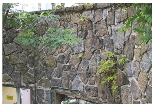
Figura 5.14. Alvenaria de pedra, embasamento da piscina. Juntas com crescimento de vegetação.
