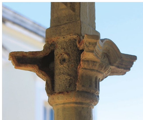
Figura 5.92. Lacuna resultante da perda de peça em aço.
