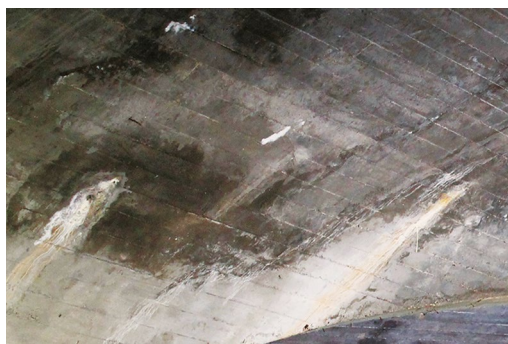
Figura 5.46. Igreja de Ascensão do Senhor. Concreções, marcas de umidade ativa e manchas de oxidação, indicando múltiplos mecanismos de degradação simultâneos.
