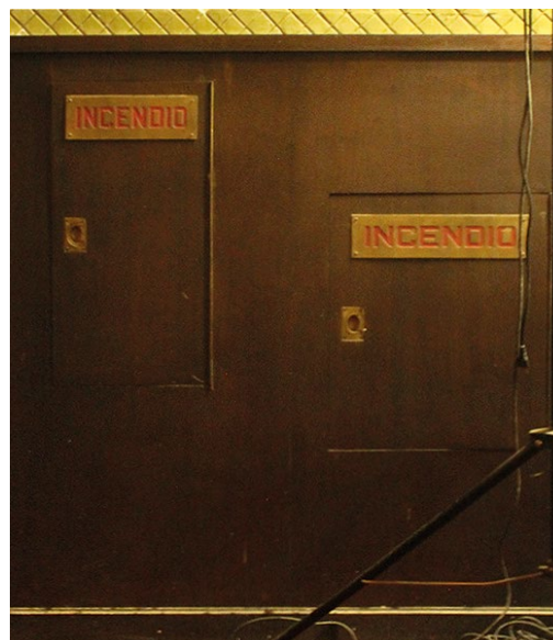
Figura 6.93. Armários para instalações de combate a incêndio na sala de espetáculos.
