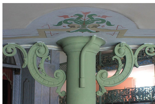
Figura 5.85. Tubulação remanescente da iluminação a acetileno.
