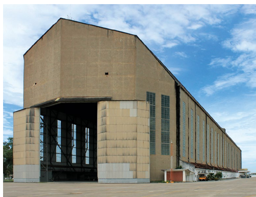
Figura 6.60. Fachada norte, com substituição parcial do fechamento em telhas de fibrocimento. 104
