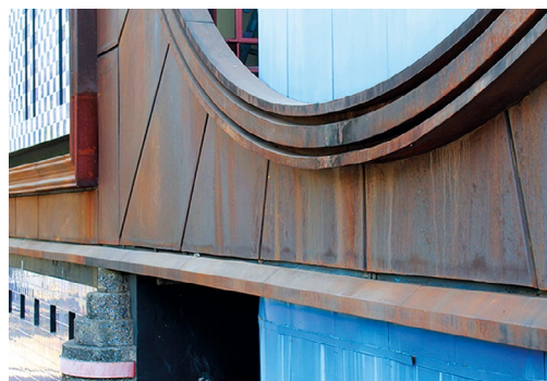
Figura 6.30. Chapas de aço patinável na fachada sudoeste, com diversas alterações cromáticas.
