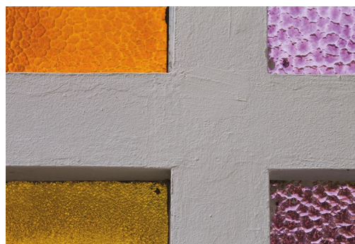
Figura 5.104. Santuário de N. S. de Fátima. Vitral. Observar variações de textura e cor resultantes de diferentes momentos de fornecimento.
