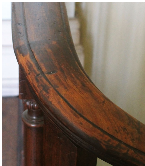
Figura 5.109. MIS-RJ. Guarda-corpo da escada remanescente, com arranhões, lacunas e alterações cromáticas associadas ao uso.
