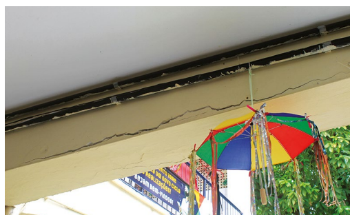
Figura 5.64. Escola Alberto Torres. Viga com fissuras indicativas de oxidação e expansão da armação metálica.
