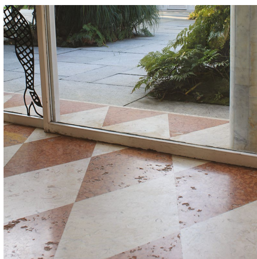
Figura 5.5. Piso da galeria do pátio. Observar desgaste do mármore rosso Verona.
