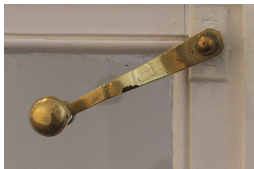
Figura 5.25. Instituto Moreira Salles. Alavanca das esquadrias. Observar arranhões e oxidação pontual.
