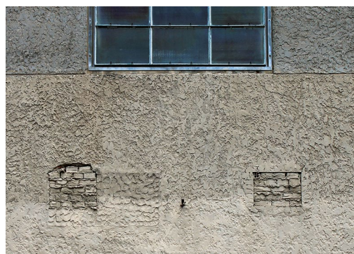
Figura 6.63. Detalhe da fachada leste. Revestimento da década de 1930, com lacunas, tentativas de recomposição e diferentes repinturas.
