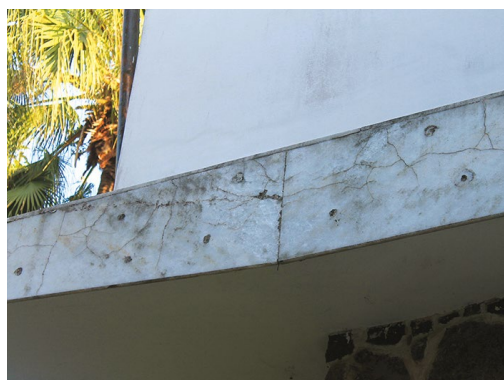
Figura 5.8. Revestimento de laje em mármore de Carrara. Marcas dos parafusos usados para fixação das peças.
