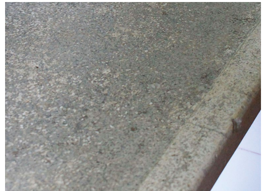
Figura 5.79. Casa da Rua Santa Cruz, em São Paulo. Bancada da cozinha, em granilite exposto à umidade. Abrasão da matriz cimentícia e textura áspera.
