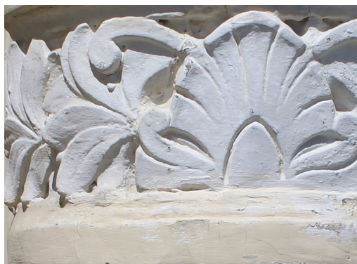
Figura 5.70. Museu da Imagem e do Som (MIS), no Rio de Janeiro. Pintura mineral sobre ornamentos em argamassa. Criação de textura pelas repinturas.
