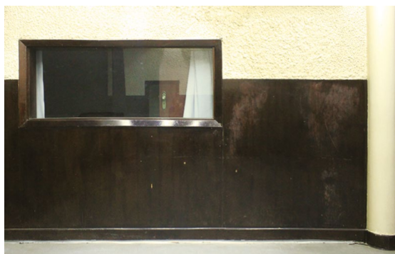
Figura 5.19. Rádio Difusora de Caruaru. Lambris do palco. Alterações cromáticas relacionadas à colonização biológica, sem maior interferência na percepção do espaço e com possibilidade de conservação de longo prazo.
