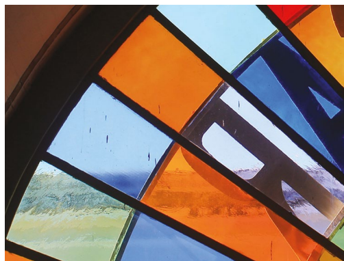
Figura 5.88. Mosaico de texturas nos vitrais, resultante do acúmulo de manutenções ao longo do tempo.
