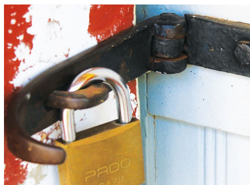
Figura 5.98. Casa da Cultura de Pires do Rio (antiga estação ferroviária). Textura resultante das sucessivas repinturas sobre as ferragens.
