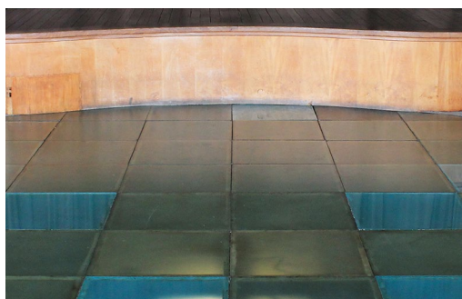
Figura 8.56. Placas de vidro do auditório. Variações no fornecimento ao longo das ações de manutenção.
