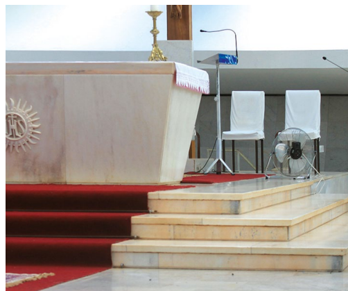
Figura 5.31. Catedral de Brasília. Mármore em placas, no piso do presbitério, com alterações cromáticas que remetem a seu uso continuado.
