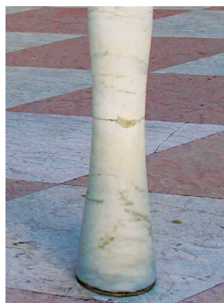
Figura 5.23. Instituto Moreira Salles. Balaústre em mármore de Carrara. Observar fratura da peça.
