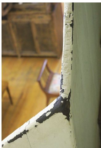
Figura 5.115. Casa da Neni. Desgaste da pintura do guarda-corpo das escadas, resultante do uso continuado.
