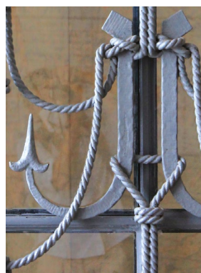
Figura 5.96. Centro Administrativo do Tribunal de Justiça do Rio de Janeiro (TJRJ), antigo entreposto de pesca. Textura resultante das sucessivas repinturas da esquadria de acesso.
