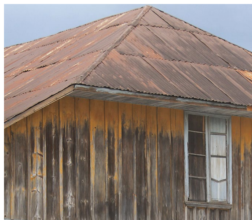
Figura 5.116. Cantina de vinhos. Fachada em tabuado de madeira, com perda parcial de pintura e alterações cromáticas resultantes da exposição aos agentes atmosféricos.
