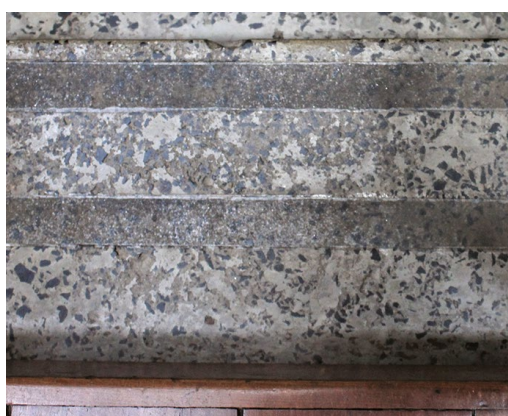
Figura 5.52. Sociedade Harmonia de Tênis. Degraus em concreto aparente, com agregado exposto, e padrão de desgaste com numerosas pequenas lacunas, associado ao uso.
