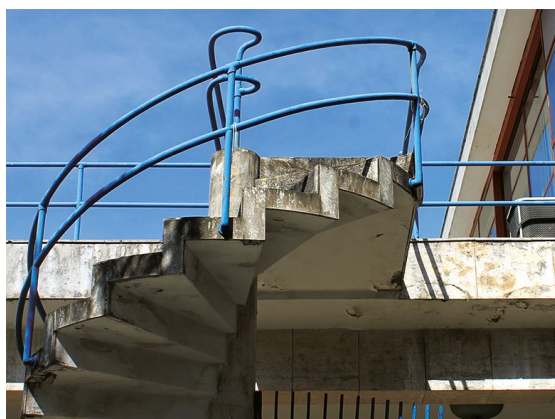
Figura 5.28. Sede do Instituto Histórico-Cultural da Aeronáutica (Incaer), no Rio de Janeiro. Antiga Estação de hidroaviões. O mármore em placas delgadas do exterior encontra-se intensamente alterado, com lacunas, deslocamento, alterações superficiais e colonização biológica.
