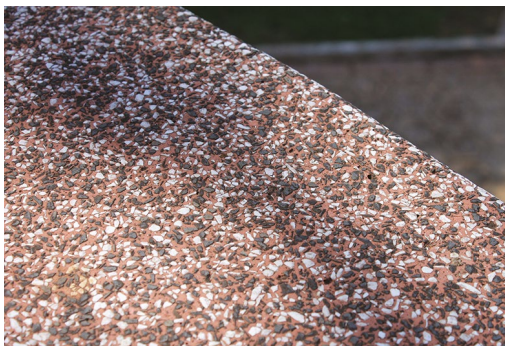
Figura 5.80. Museu Pedro Ludovico, em Goiânia. Guarda-corpo exposto aos agentes atmosféricos. Abrasão da matriz cimentícia e textura áspera.
