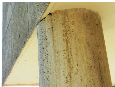
Figura 8.45. À esquerda. Granito juparaná das fachadas. Superfície plana, íntegra e arestas vivas.
