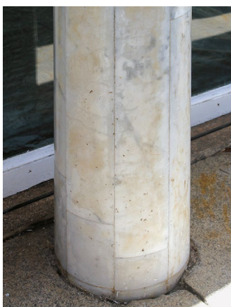
Figura 5.22. Instituto Moreira Salles. Revestimento de pilar em mármore de Carrara. Observar amarelecimento.
