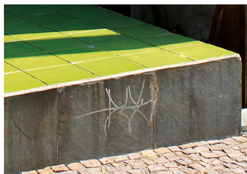
Figura 6.31. Revestimentos em ardósia e cerâmica na fachada leste, mostrando pequenas lacunas.
