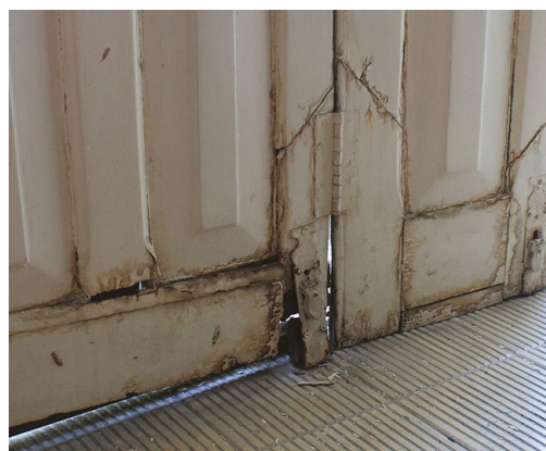
Figura 5.87. Esquadrias da fachada lateral. Marcas de substituição parcial e de degradação, que requer novas substituições parciais.
