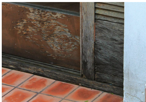
Figura 7.18. Esquadrias de madeira do quarto sudeste. Perda de tratamento superficial, abertura das fibras e desgaste em algumas peças.
