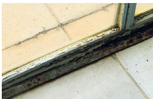
Figura 8.58. Caixilhos em aço. Situação de degradação.
