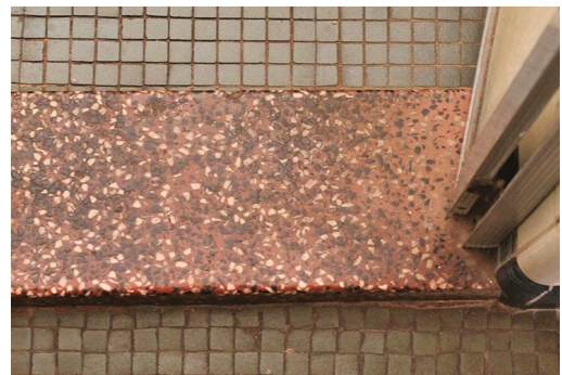
Figura 5.81. Museu Pedro Ludovico. Soleira de banheiro. Diferentes graus de exposição geraram abrasão da matriz cimentícia na parte esquerda da peça.
