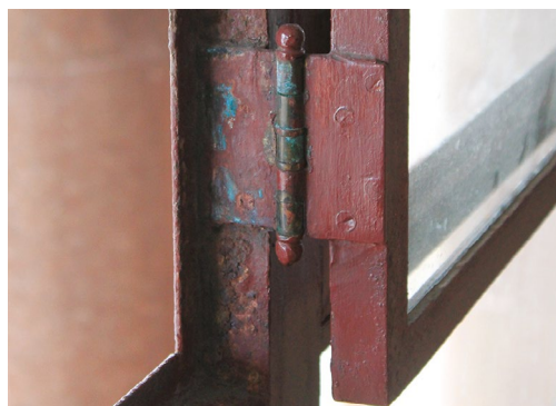
Figura 6.97. Esquadrias de aço do foyer superior, com oxidação e superfície repintada irregular.
