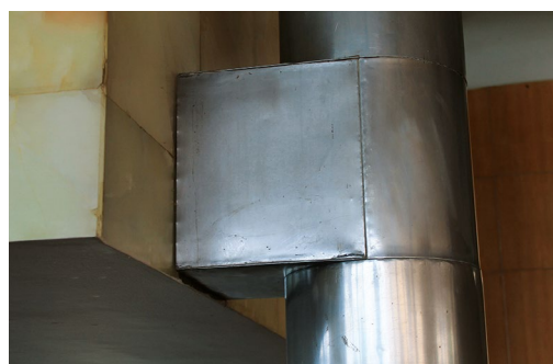
Figura 8.51. Pilar da galeria e console de sustentação do mezanino. Marcas do acabamento e fixação das folhas de aço inoxidável.
