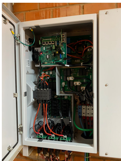
(c) Vista geral da entrada dos arranjos FV e saída em CA
