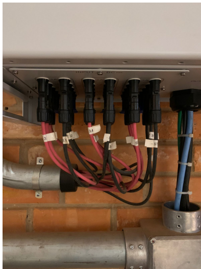
(a) Entrada dos arranjos FV
