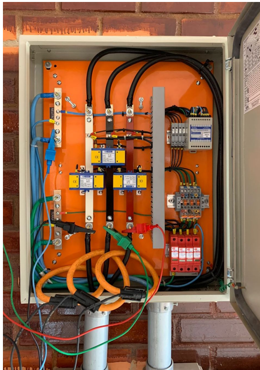
(a) Instalação do analisador de energia no quadro de interface do subsistema 1
