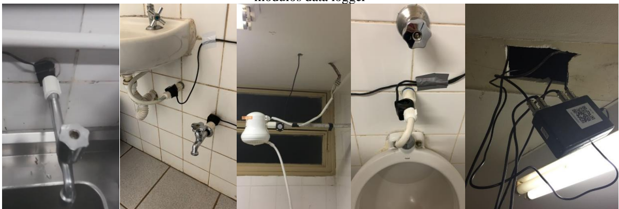
Figura 9 – Medidores de fluxo instalados em torneiras, chuveiros, mictórios e filtros de água, conectados a módulos data logger
