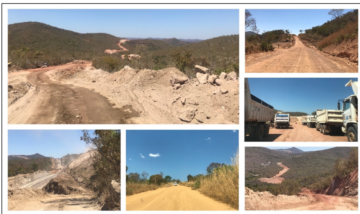
Figura 60 - Abertura de vias de acesso ao local do empreendimento da SVPM (ago./2021)
