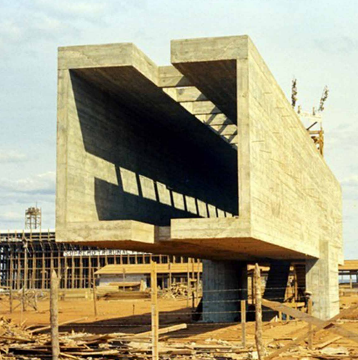
68. Foto da construção do Museu da Cidade, 1958. Fotografia sem autoria especificada. Arquivo Público do Distrito Federal, retirado de Soares (2017).
