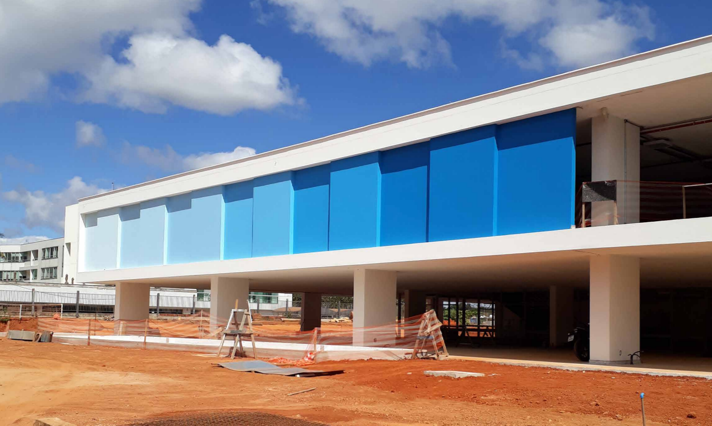
253. Fachada posterior do MAB nas etapas finais da reforma, julho de 2020. Fotografia da autora.
