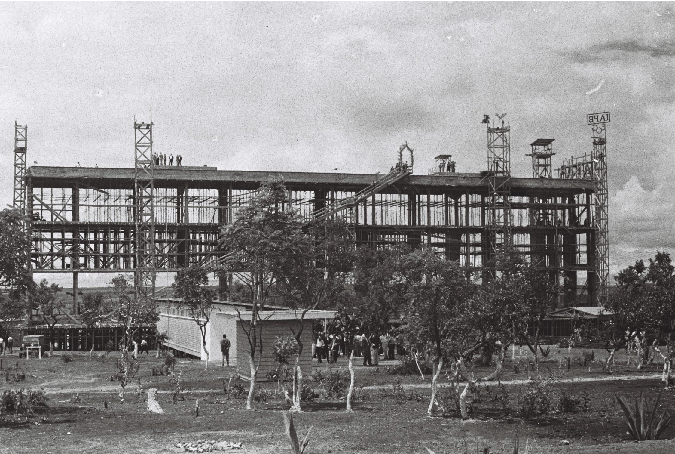
Figura 83 – Foto da construção de bloco do IAPB que mostra a concretagem intercalada das lajes dos pavimentos e as torres de madeira utilizadas no canteiro. Fonte: Arquivo Público do DF.
