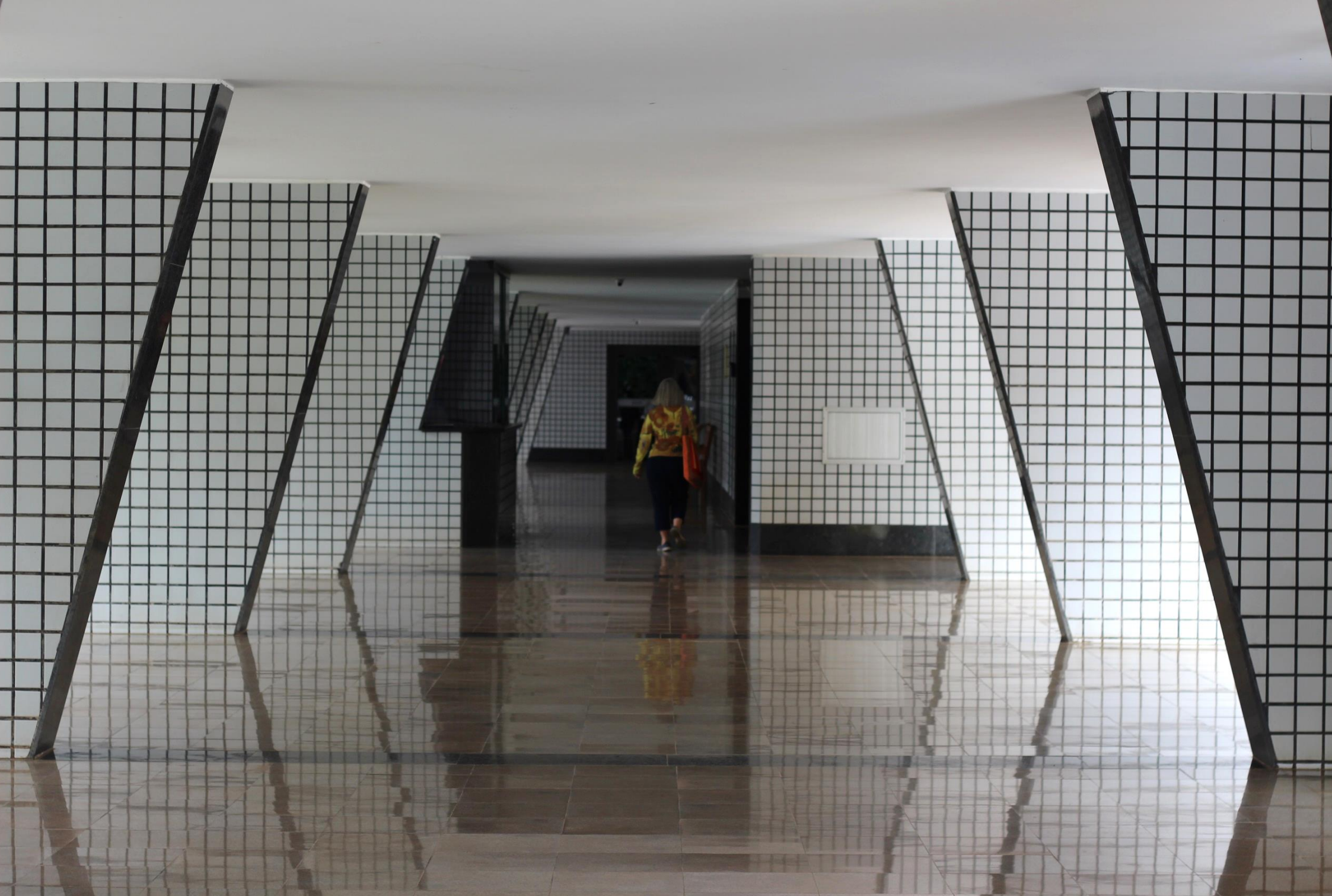
Figura 216 –Descaracterização dos materiais do pilotis do bloco B, 2019. Fonte: autora.
