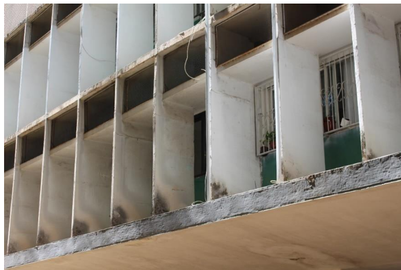
Figura 177 – Desgastes materiais na trama de brises em concreto do bloco A. Foto: autora
