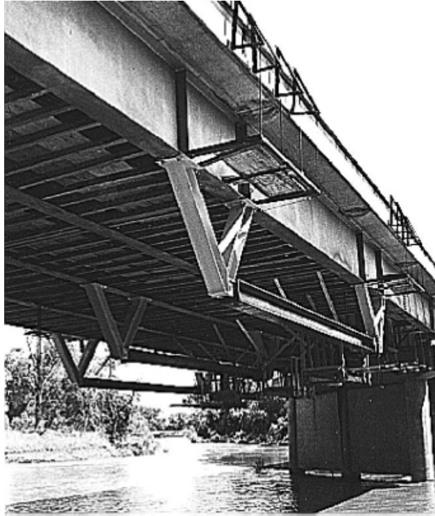
Figura 2.13 - Ponte Walnut Creek, auto-estrada I-35, Estados Unidos com amortecedores semi-ativos.
