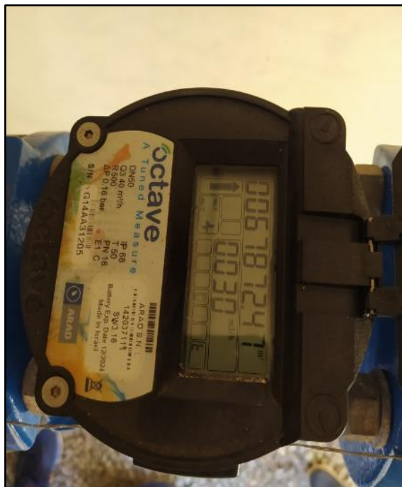
Figura 16 – Hidrômetro geral (macromedidor) da área de estudo.
