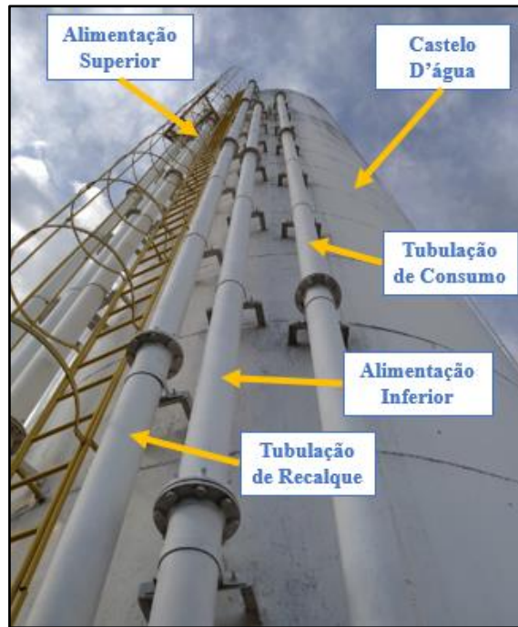
Figura 14 – Outro detalhe do reservatório do condomínio (Castelo D'água) e tubulações a ele vinculadas.
