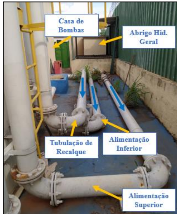
Figura 12 – Tubulações de alimentação do reservatório do condomínio.
