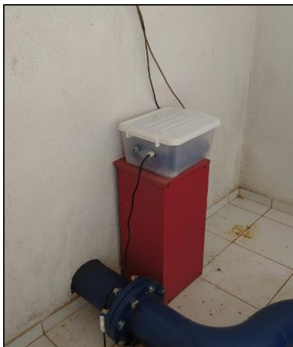
Figura 22 – Medidor + data logges + computador portátil, instalados na casa de bombas.
