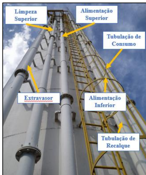
Figura 13– Reservatório do condomínio (Castelo D'água) e tubulações a ele vinculadas.
