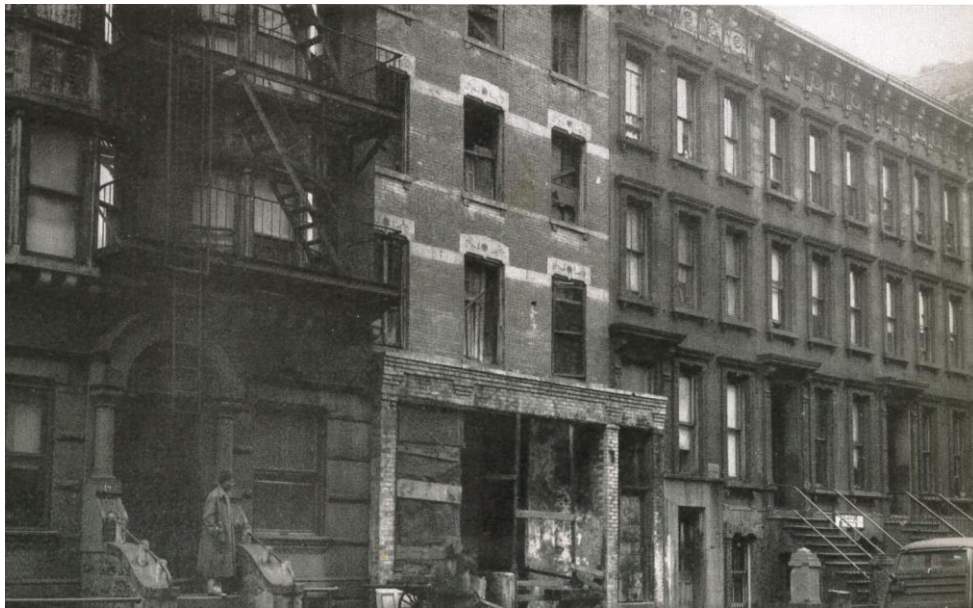
Figura 4 - Quarteirão em condição de deterioração no bairro de Harlem
