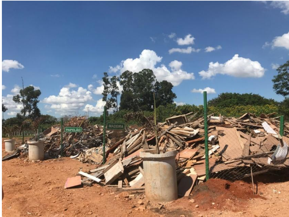
Figura 16 – Local de deposição de resíduos após triagem por classes B, C ou D, ou seja, madeira, plásticos, papelão, ferro, dentre outros, na URE da Estrutural - DF
