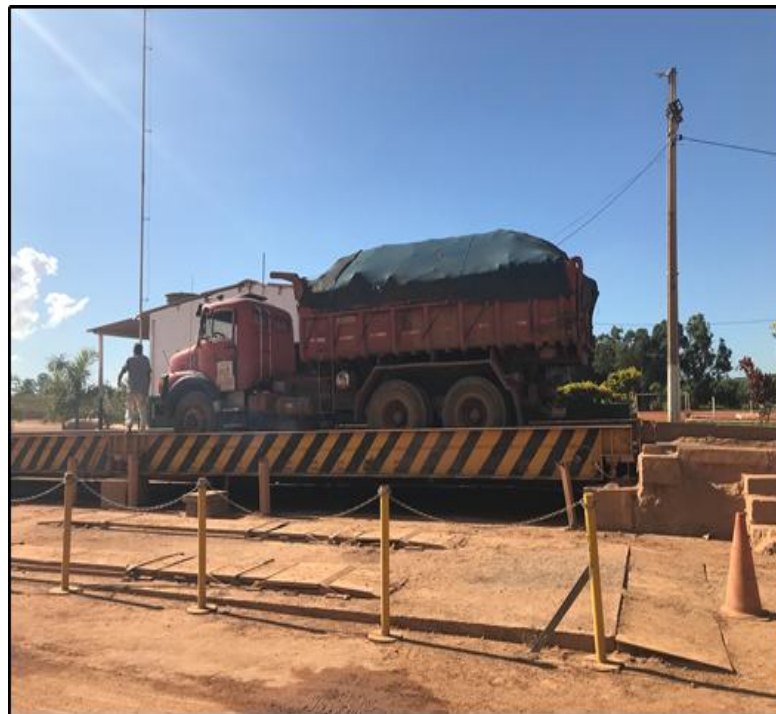
Figura 15 – Balança de pesagem de entrada de resíduos da URE da Estrutural
