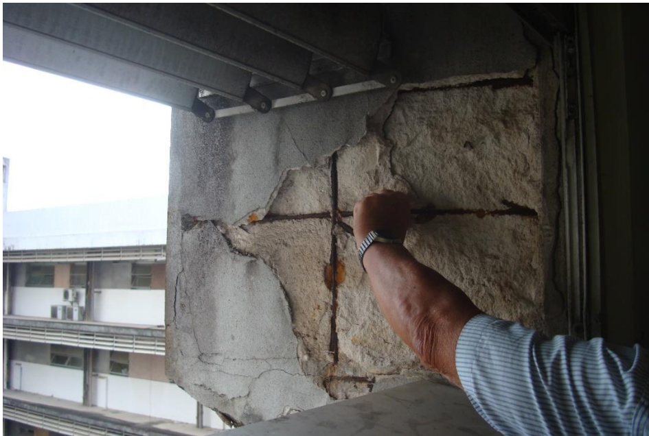
Imagem 3 - Fotografia do brise soleil com armadura exposta.
