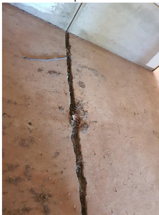
Foto 15 – Contrapiso do 1º Pavimento
