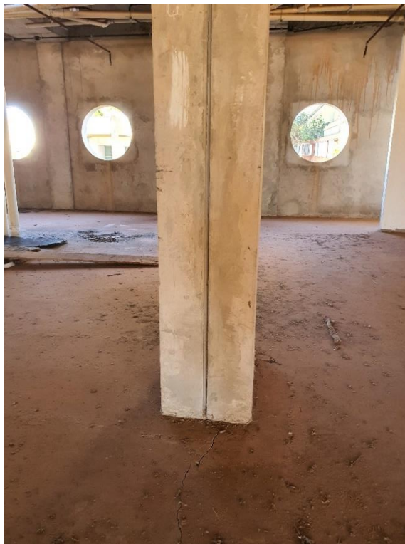
Foto 7 - Falta de Junta de Dilatação no Térreo
