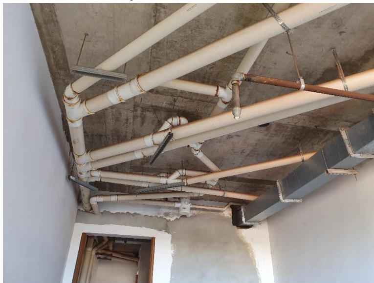
Foto 14 - Instalação Hidrossanitária do 1º Pavimento
