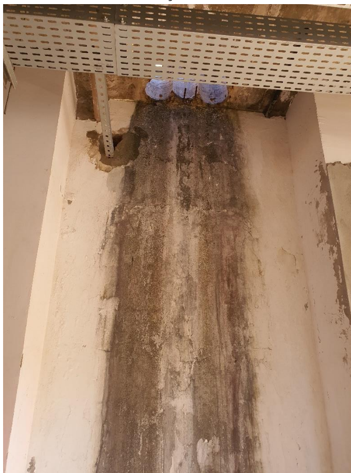
Foto 26 - Infiltração no 2º Pavimento
