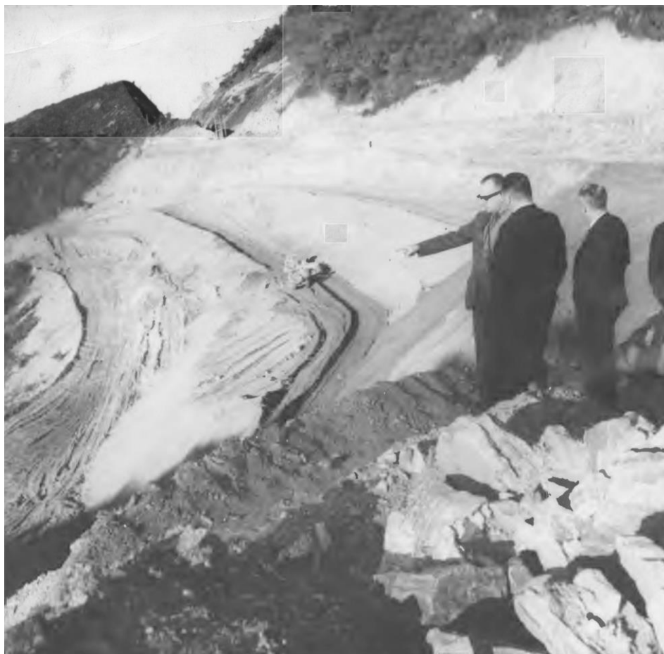
Figura 25. O engenheiro Jorge de Abreu Schilling, diretor da Central do Brasil, inspeciona as obras de terraplenagem do percurso Pirapora-Brasília em Minas Gerais, que permitiria a viagem em bitola larga até a nova capital. O setor estava sob a responsabilidade do engenheiro Wilson Lobato Martins. 18/07/1962. Fonte: Fundo Arquivo da Manhã, Arquivo Nacional.
