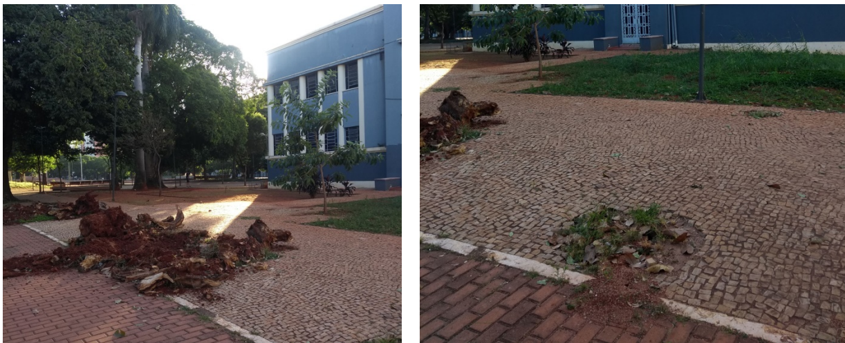
Figura 8: Calçamento danificado e entulho, ao lado do Museu Zoroastro Artiaga.
